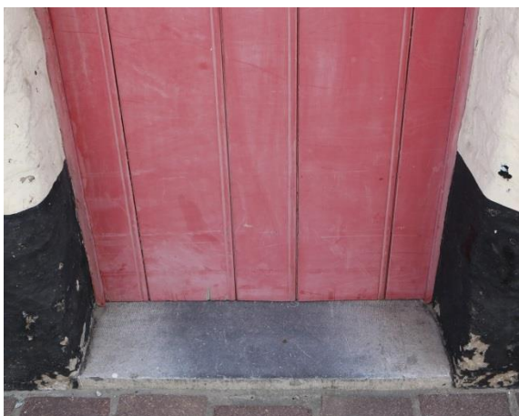
Figuur 24 Onderzijde deur woning nr. 81 (03.07.2019)
