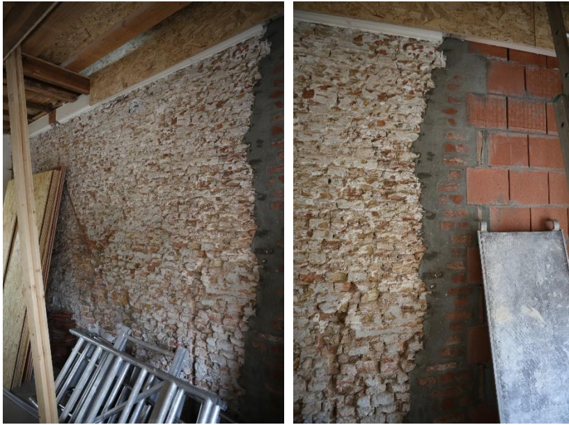
Figuur 41 Afgekapte bepleistering woning nr.81 (03.09.2020) & Figuur 42 Gebruik van cementmortel in woning nr. 81 (03.09.2020)
