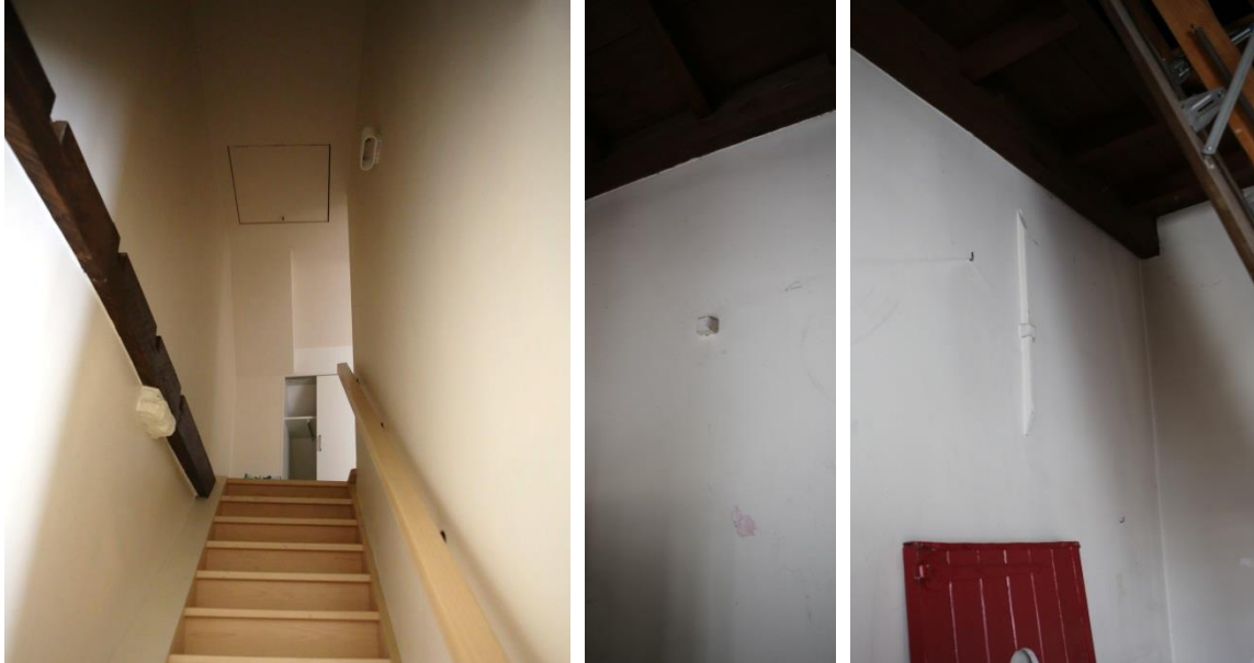
Figuur 48 Console in woning 79 (08.08.2019), Figuur 49 Ankerroog in woning nr. 83 (08.08.2019), Figuur 50 Muuranker in woning nr. 83 (08.08.2019)
