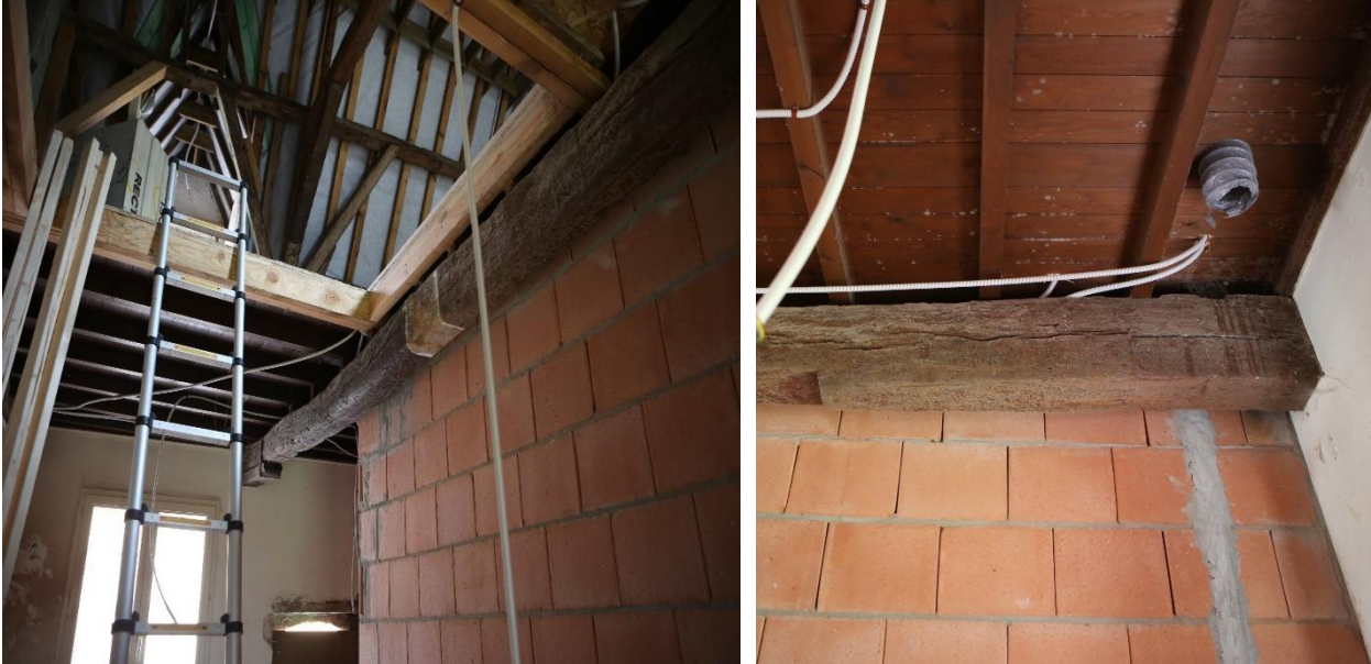
Figuur 38 Behouden moerbalk woning nr. 81 (03.09.2020) & Figuur 39 Behouden balk, woning nr. 81 (03.09.2020)
