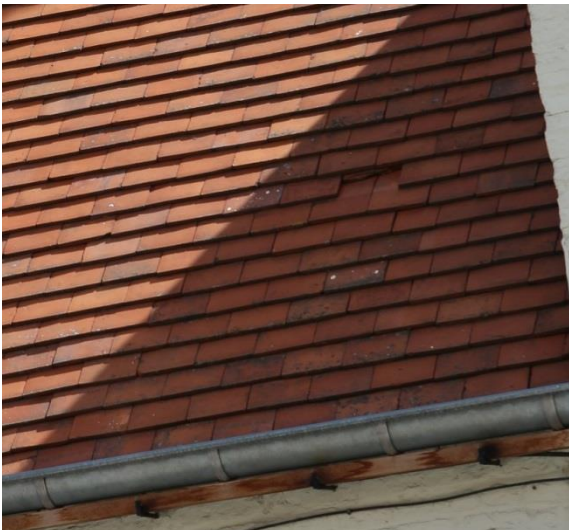
Figuur 20 Afgebroken tegelpan vooraan woning nr. 79 (03.07.2019)
