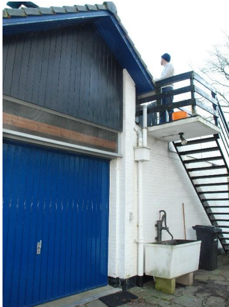
Afb. 113: garage en trap naar het terras boven de aanbouw van 1978. Let op de slordig geplaatste afvoerbuis en vergaarbak in pvc
