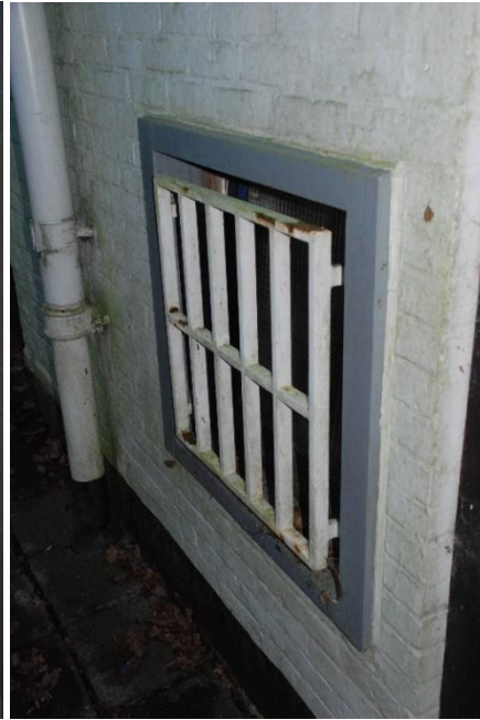
Afb.100: zelfde locatie met zicht op kelderraam met diefijzers en volumineuze afvoerbuis in pvc.
