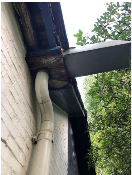
Afb.101: aangetaste goot en dakoverstek aanbouw 1962. De nieuwe zalinggoot is storend
