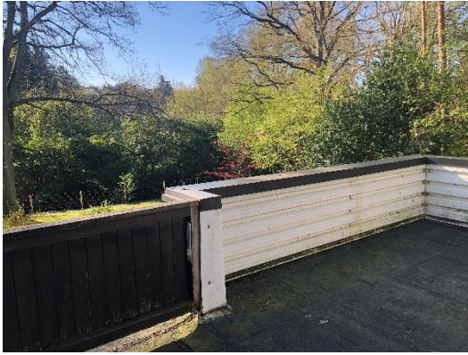
Afb. 117: zicht op terras met links balustrade in hout en rechts storende balustrade in pvc
