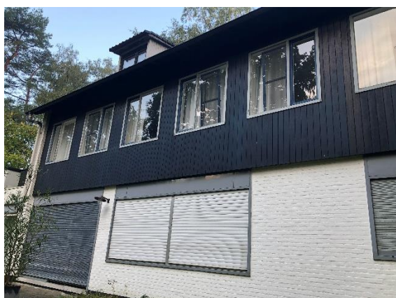
Afb. 108: zicht op de storende rolluiken uit pvc.
