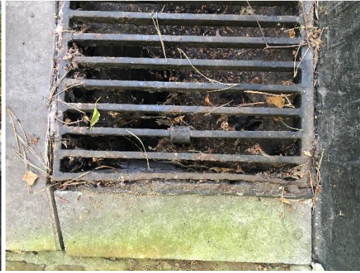
Afb. 118: metalen kelderrooster dat door vocht is verroest en uitgezet.
