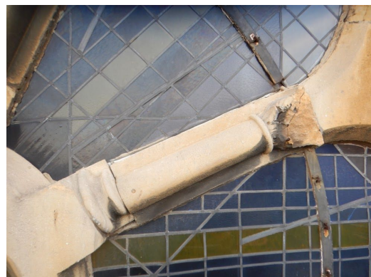
roosvenster: detail verzakt en beschadigd element
