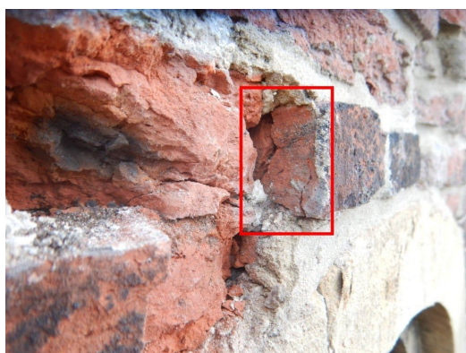
toren [1]-zuidwest: gescheurde baksteen
