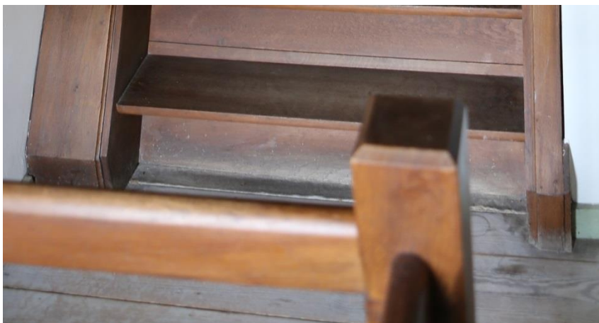
Figuur 113 Gebruiksschade onderzijde zoldertrap (dd. 08.08.2019)
