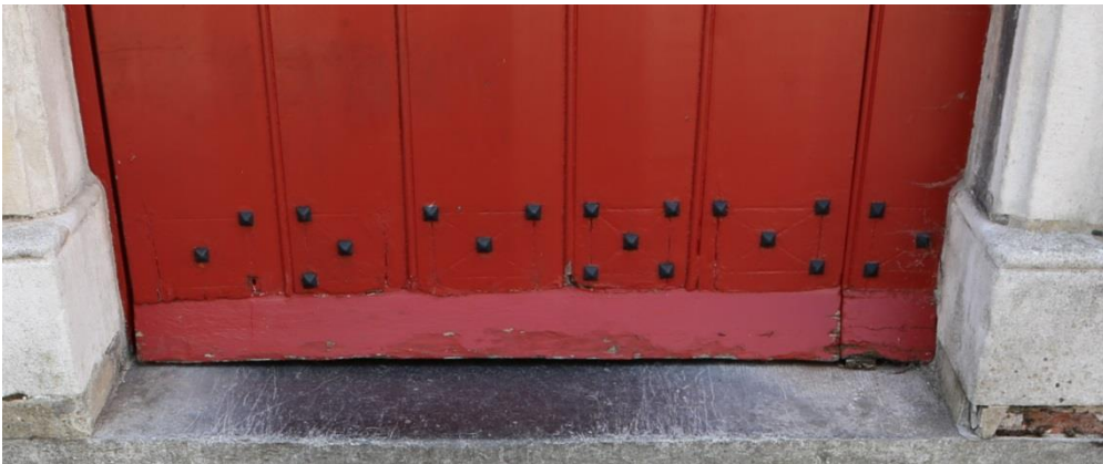
Figuur 51 Schadebeeld onderzijde voordeur (dd. 03.07.2019)
