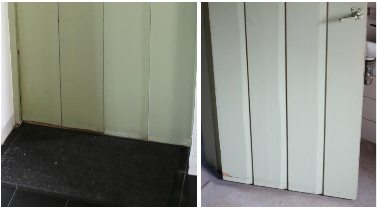
Figuur 117 Onderzijde toegangsdeur woning 2 (dd. 08.08.2019) & Figuur 118 Gebruiksschade badkamerdeur woning 4 (dd. 08.08.2019)
