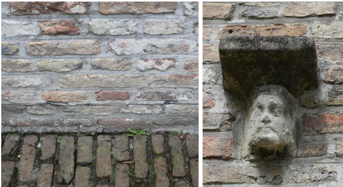
Figuur 35 Uitvallend voegwerk achtergevel (dd. 08.08.2019) & Figuur 36 Huidige toestand console achtergevel (dd.08.08.2019)
