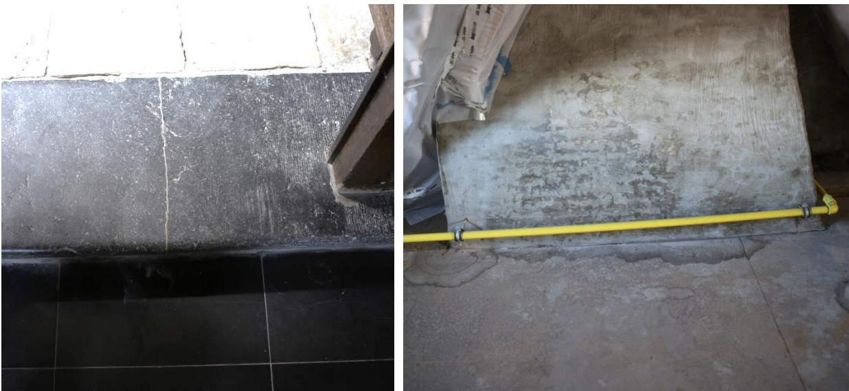
Figuur 107 Gebroken trede tussen kapel en inkomhal (dd. 08.08.2019) & Figuur 108 Vochtschade op zolder (dd. 08.08.2019)
