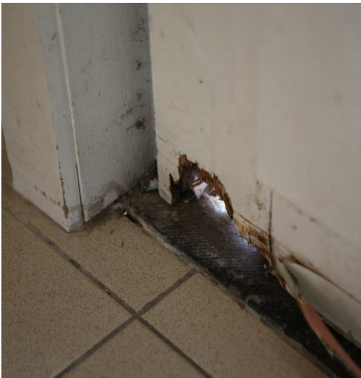
Figuur 81 Schade onderzijde achterdeur (dd. 08.08.2019)
