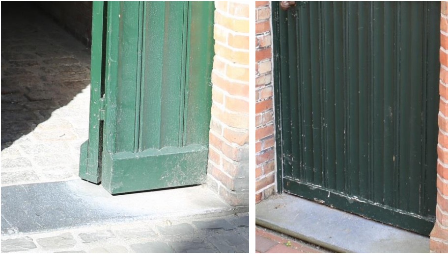
Figuur 79 Detail van de onderzijde van de onderzijde van de inkompoort (dd. 08.08.2019) & Figuur 80 Detail van de onderzijde van een voordeur (dd. 08.08.2019)
