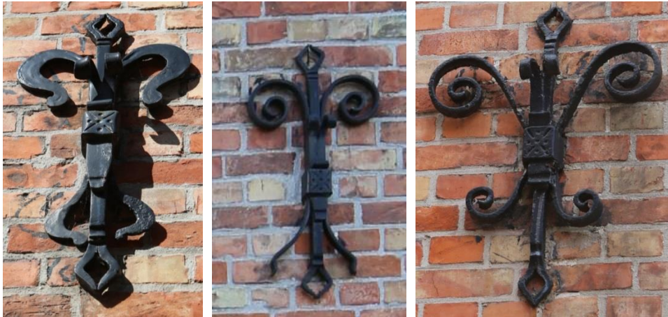
Figuur 93 Muuranker woning nr. 29 (dd. 08.08.2019), Figuur 94 Muuranker woning 35 (dd. 08.08.2019) & Figuur 95 Muuranker woning 37 (dd. 08.08.2019)
