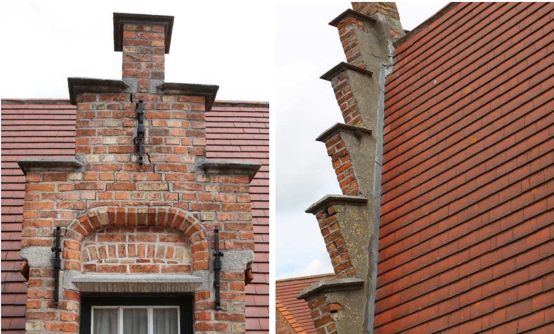
Figuur 64 Scheurvorming trapgevel kapel (dd. 08.08.2019) & Figuur 65 Afvallen en loskomen cementering achterzijde topgevel (dd. 08.08.2019)
