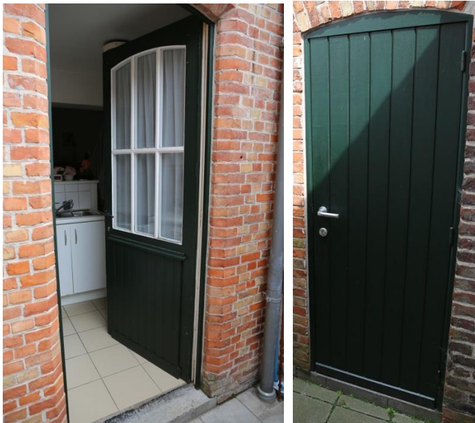
Figuur 77 Keukendeur woning (dd. 08.08.2019) & Figuur 78 Deur berging koer (dd. 08.08.2019)
