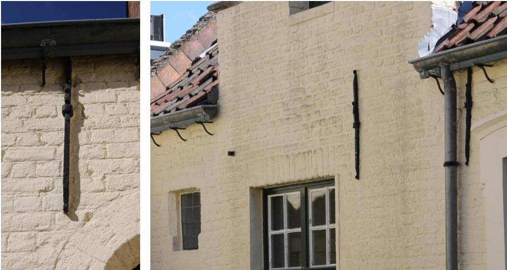
Figuur 62 Muuranker tuingevel woning straatzijde (04.07.2019) & Figuur 63 Ontbrekend muuranker achterste woning (04.07.2019)
