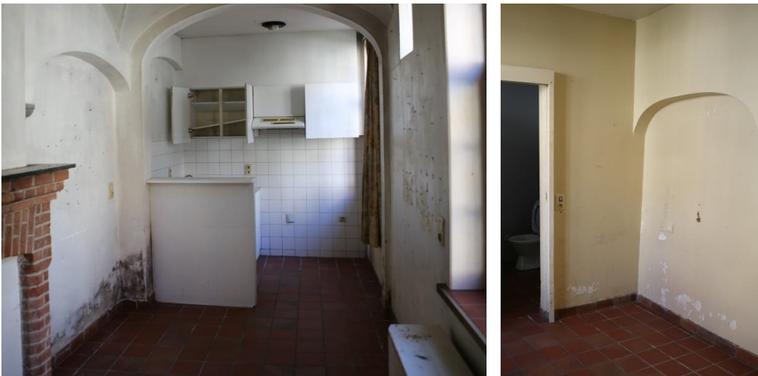
Figuur 79 & Figuur 80 Schadebeeld wanden woning achterzijde (04.07.2019)
