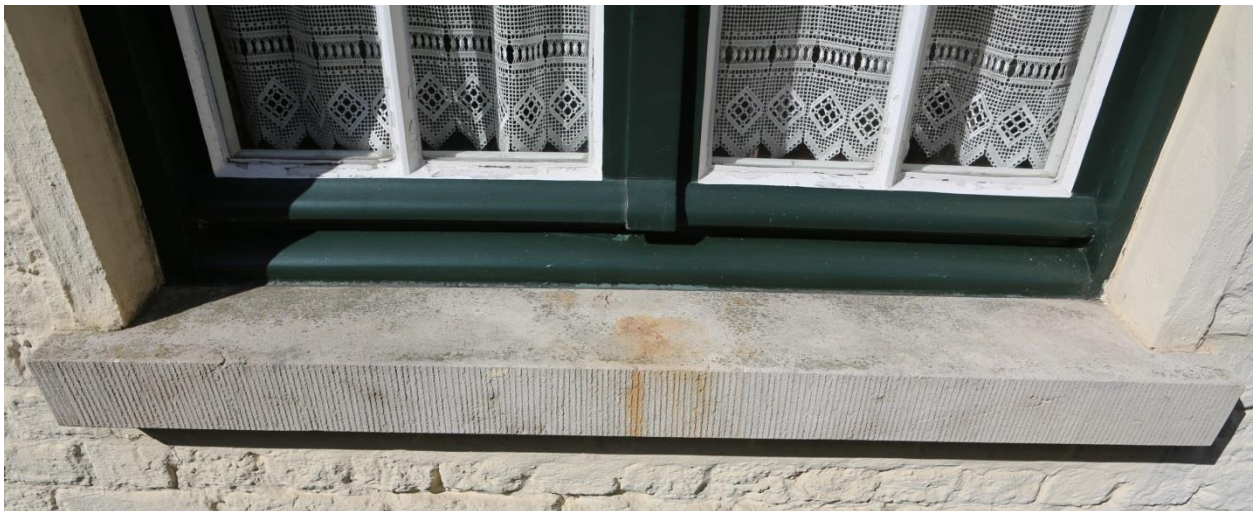
Figuur 59 Schadebeeld houten schrijnwerk tuingevel woning straatzijde (04.07.2019)
