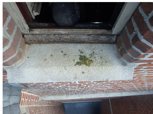
Licht ingerot houtwerk.
