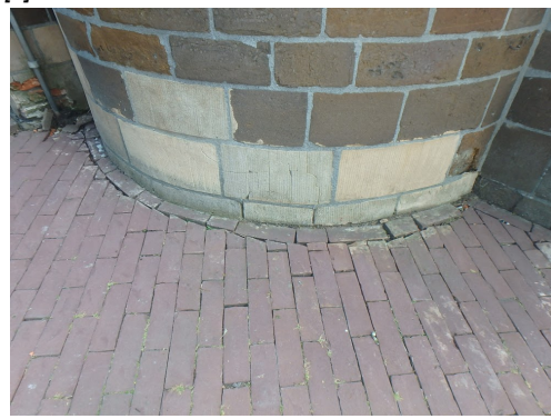
Gearsten en weggevallen mortelherstelling onderaan toren [6].
