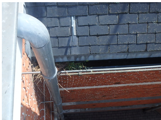
De goot is vervuild vanwege het slechte afschot.
