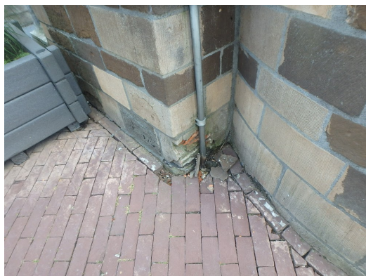
Beschadigde mortelherstelling aan toren [1]-zuidwest.
