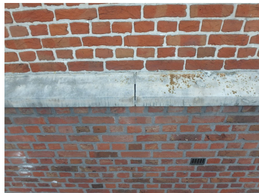
Uitgespoelde voeg van de waterlijst van vleugel [5]-zuid.
