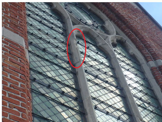
Vleugel [5]-zuid: deels weggevallen mortelherstelling deels ingescheurde mortelherstelling.
