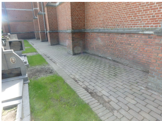
Uitgespoeld voegwerk ter hoogte van het maaiveld.
