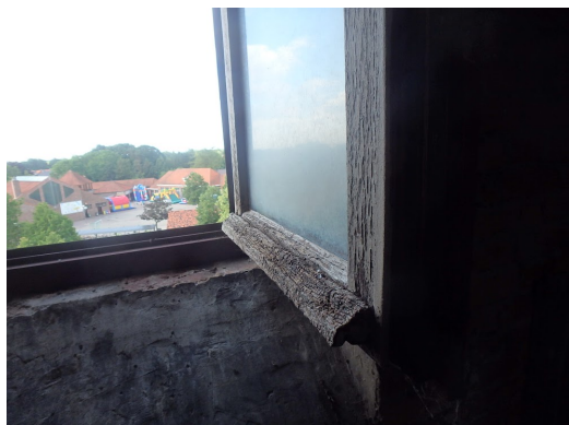
Licht ingerot houtwerk.
