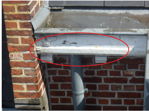
Afbladderend schilderwerk van de kroonlijst aan vleugel [1]-zuidwest.
