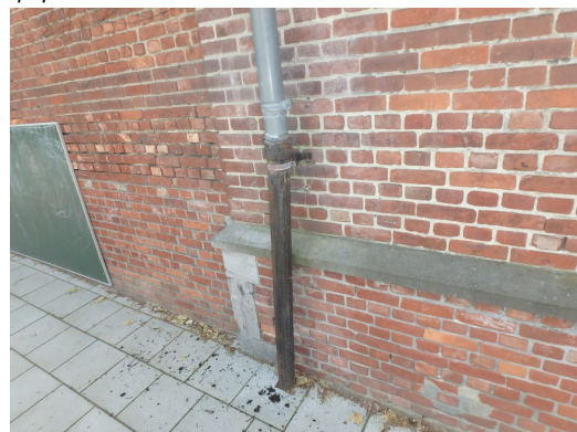
Uitgespoelde zone voegwerk aan vleugel [5]-noord.
