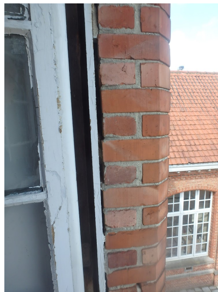
Weggevalen voegwerk met de dagkant van de houten ramen.
