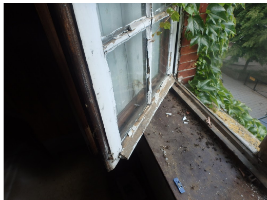
Afbladderend schilderwerk en weggefallen stopverfaanwerking met een raam aan vleugel [1]-oost.
