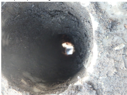
Dak [1]-noordwest: gat in het bovenste bochtstuk.
