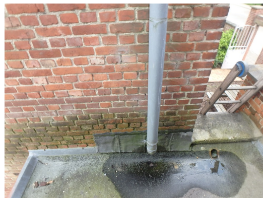
Uitgespoelde zone voegwerk ten gevolge van opspattend water.
