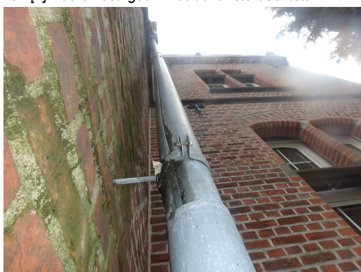
Dak [1]-zuidwestelijke hoek: deels opengeplooid naad van de afvoer.
