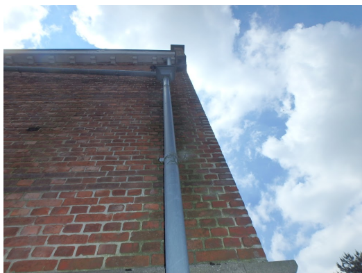
Dak [1]-noordwest: vochtoverlast ten gevolge van verstopte tapbuis/vergaarbak.
