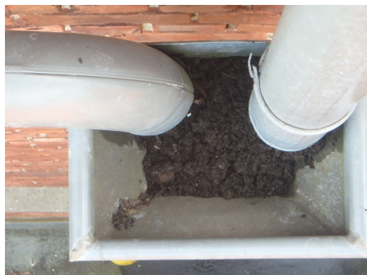
Dak [1]-noordwest: verstopte vergaarbak.
