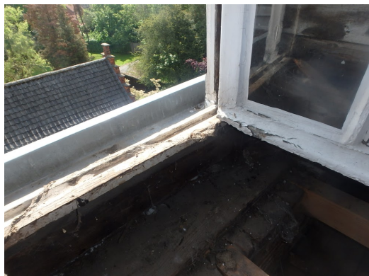
Afbladderend schilderwerk van de oostelijke dakkapel van dak [2].
