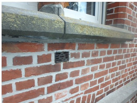
Uitgespoeld voegwerk van een raamdorpel.
