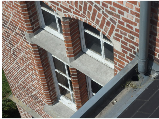
Afbladderend schilderwerk van een raam aan vleugel [2]-oost.
