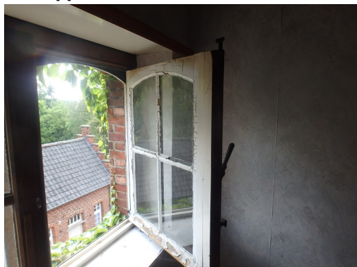
Afbladderend schilderwerk aan een raam van vleugel
