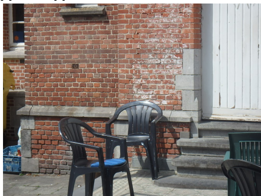
sterk uitgespoeld voegwerk aan de plint van vleugel [1]-oost en [3]-oost.
