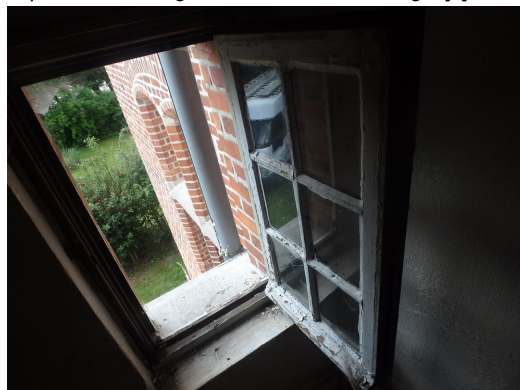
Afbladderend schilderwerk van een raam aan vleugel
