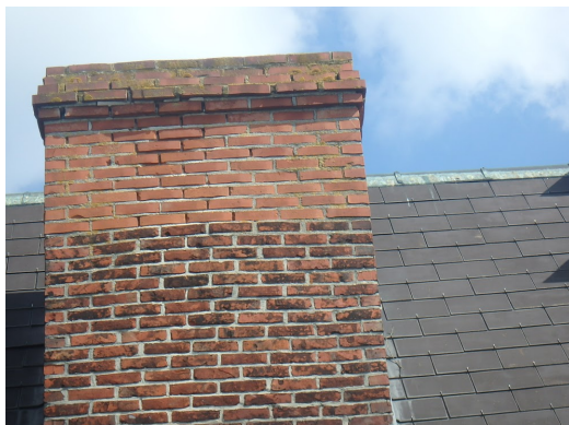
Uitgespoelde zone voegwerk aan de schoorsteen van dak [1]-zuidoost.
