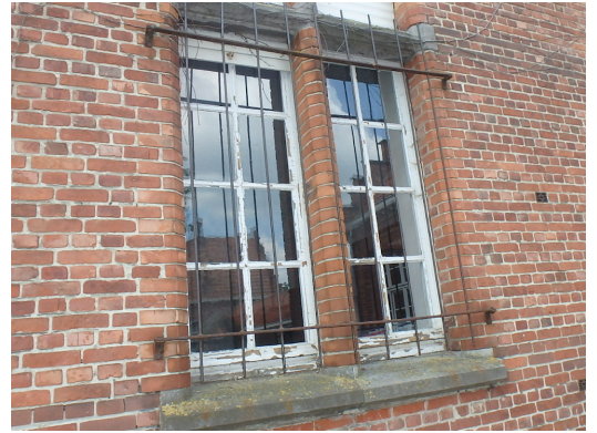
Afbladderend schilderwerk van een raam aan vleugel [1]-noord.
