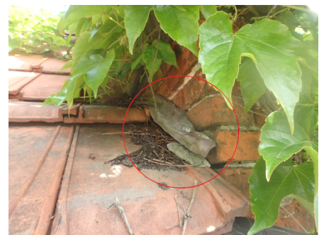
Vleugel [5]-zuidoost: wegzakkende loodaansluiting.
