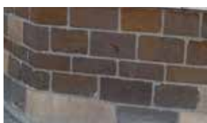
afb. 150: IJzerzandsteen met reparaties van gele natuursteen
