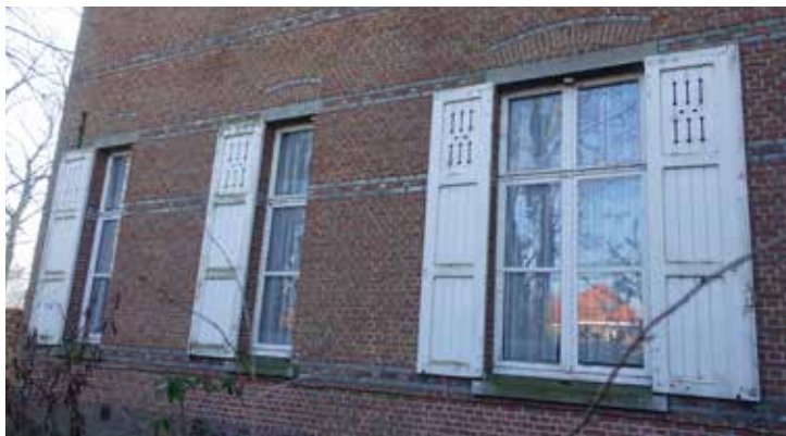
afb. 305: Algemeen achterstallig onderhoud van het schrijnwerk
