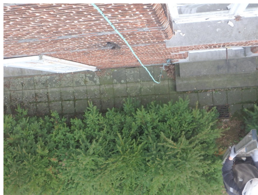
Gevelleiding hangt los.
