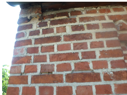
Losgescheurd voegwerk bovenaan de noordzijde van de westgevel.
