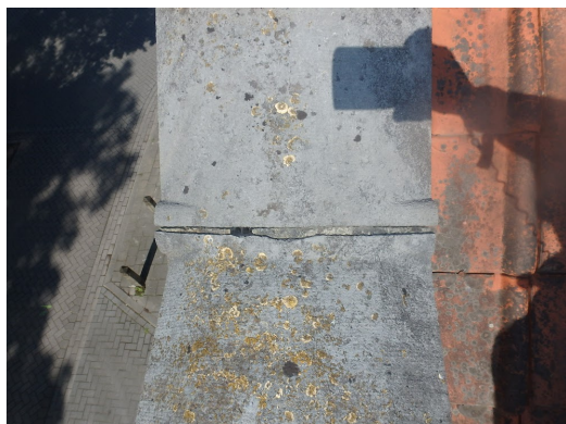
Losgescheurd voegwerk van de dekstenen.
