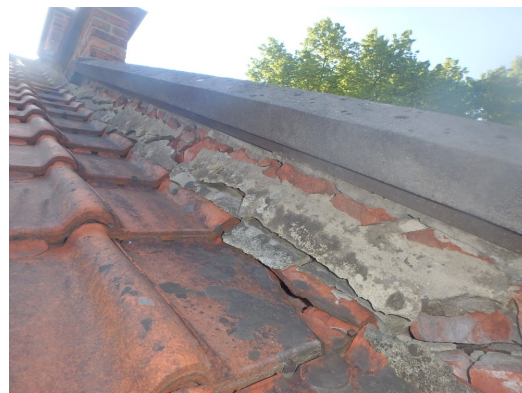
Gebarsten pan en losgescheurde mortelaanwerking.
