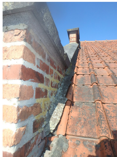
Onderaan weggevallen mortelaanwerking.
