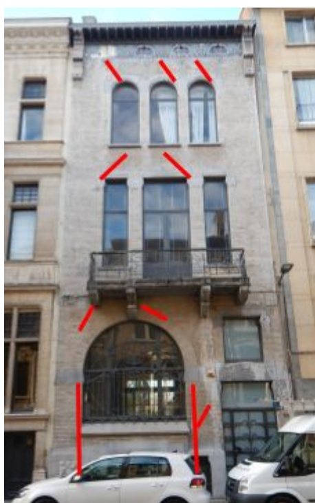
voorgevel: meest uitgesproken scheuren
