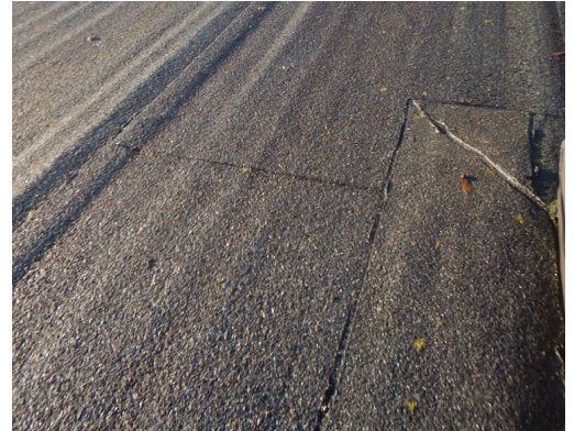
dak [1]-oost:verweerde roofing
