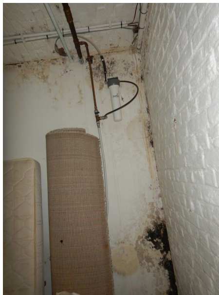
centrale ruimte: schimmel
