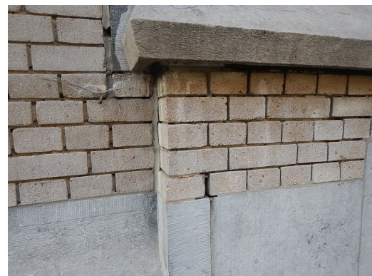
voorgevel: oppervlakkig beschadigde bakstenen en voegen
