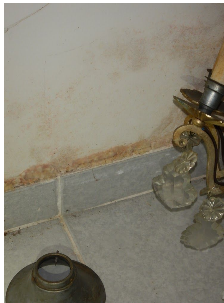
centrale ruimte: schimmel
