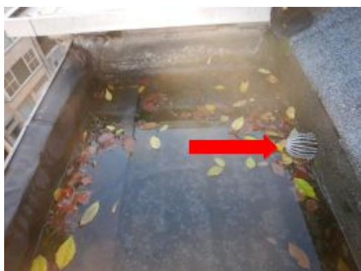
dak [1]-oost: slechte afwatering via interne afvoer
