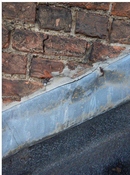
dak [1]-noord: verweerde muuraansluiting
