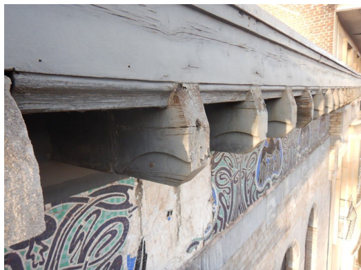
sterk beschadigde zone
