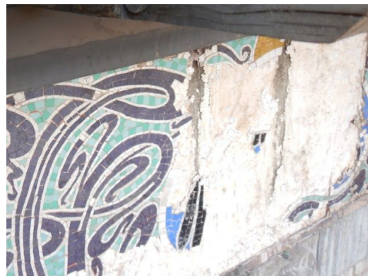
sterk beschadigde zone
