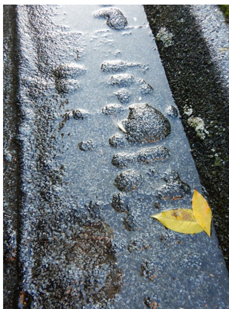
dak [3]: verweerde roofing
