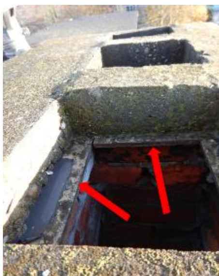
schoorsteen zuidoost: asbesthoudend plaatmateriaal
