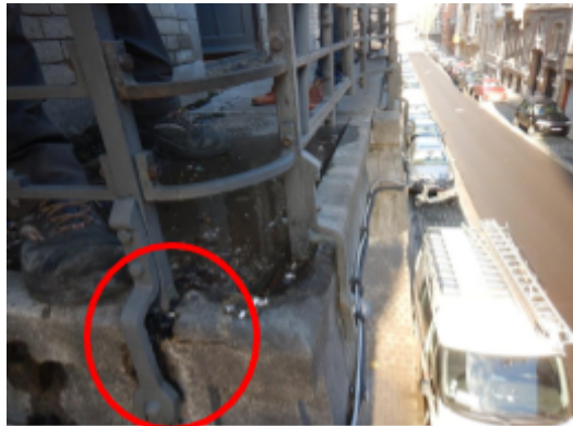
beschadigd ankerpunt met steenschade
