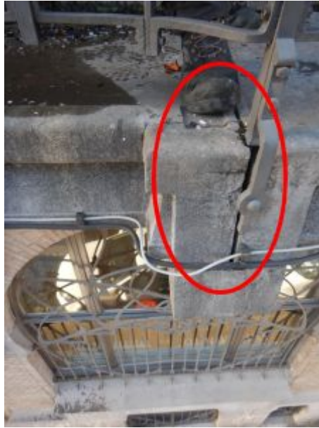
console links: beschadigd ankerpunt met steenschade + open voeg
