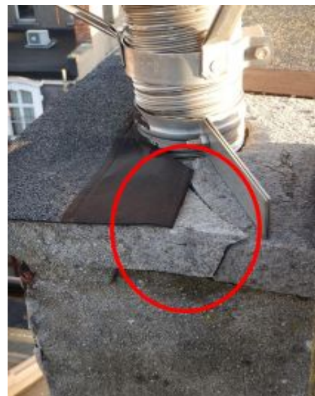
schoorsteen zuidoost: gescheurde deksteen
