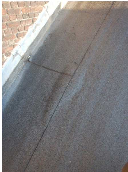
dak [1]-west: verweerde muuraansluiting + blaas
