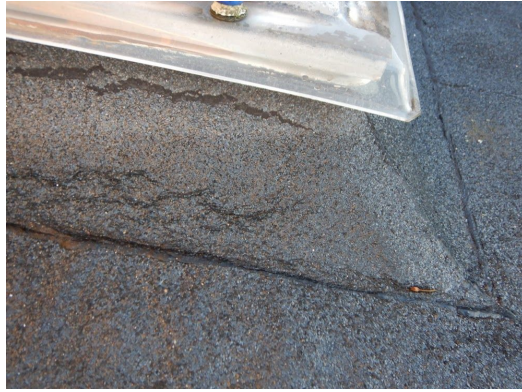
dak [1]-west:verweerde roofing aan dakdoorbreking
