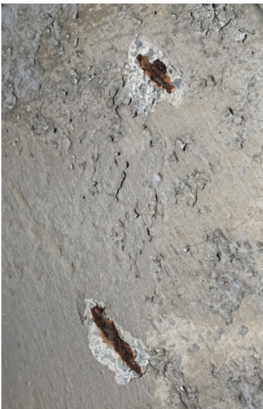
afb. 56: Geroeste wapening aan Betonnen plafond bakstenen basis.
