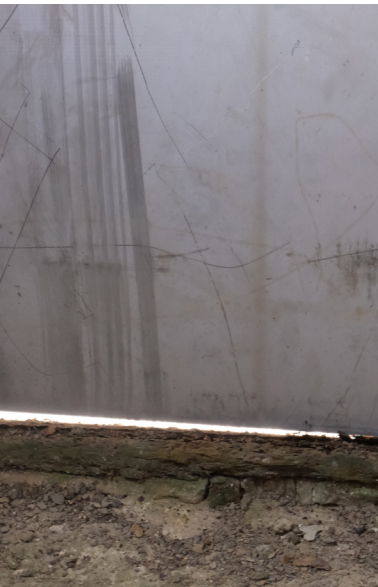
afb. 62: Gedegradeerde houten stijl van schrijnwerk aan deur aan het dak.
