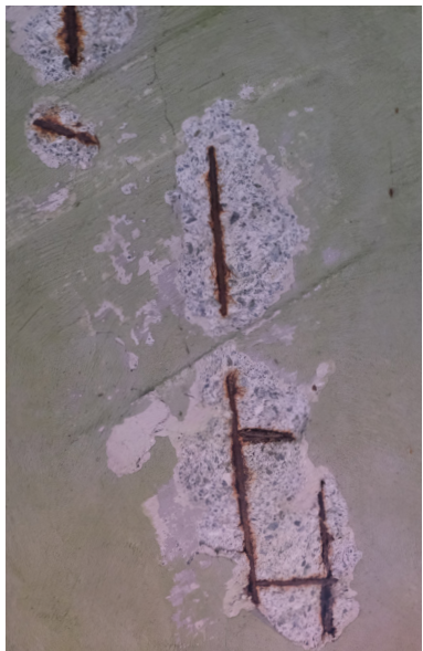
afb. 57: Geroeste wapening aan betonnen plafond dak.
