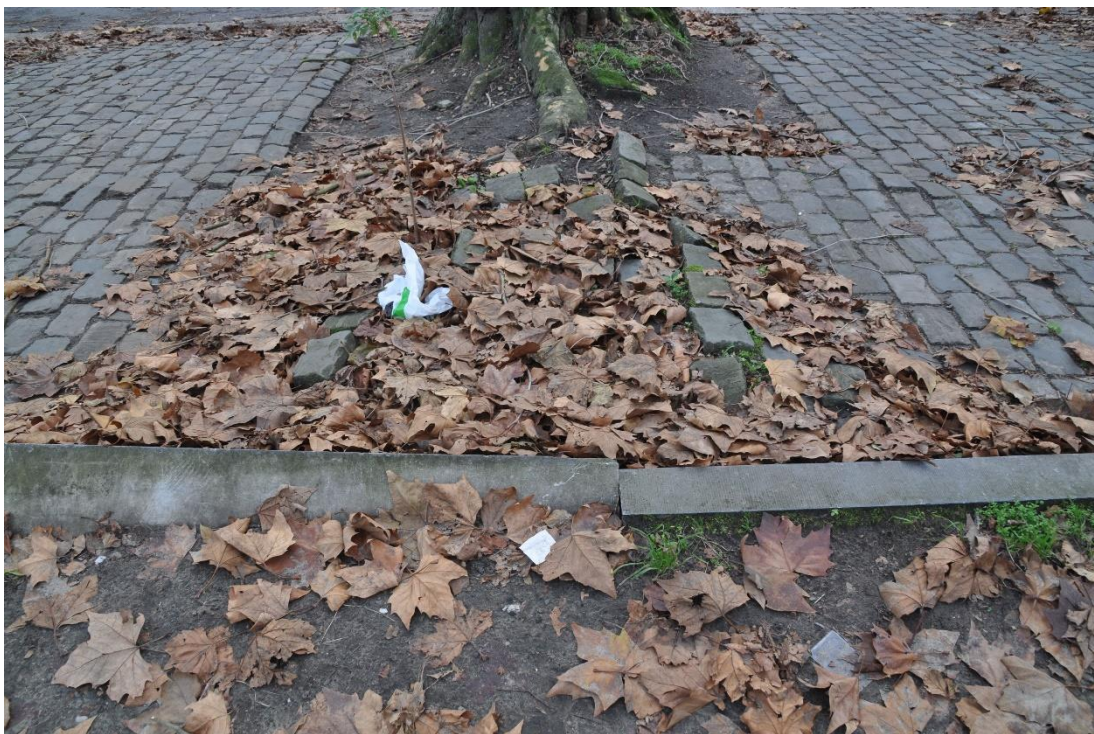
Fig. 117: Beschadigde verharding en kantopsluiting ten gevolge van worteldruk (boom 2) .
