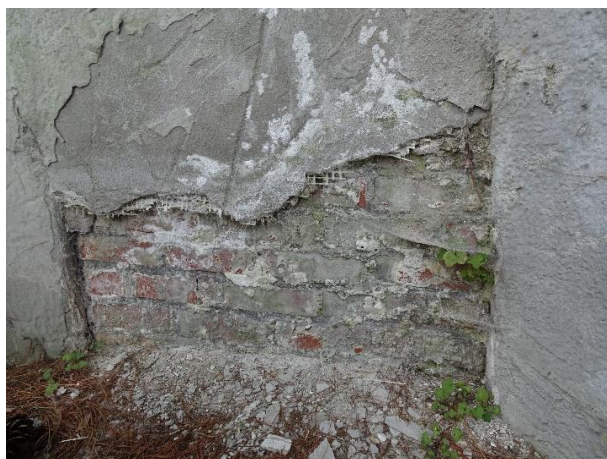
Schade aan de achterzijde, herstelpoging met jutedoek.
