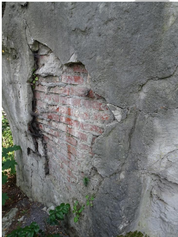
Schade door weggeroest wapeningsnet.
