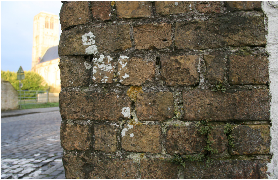
Foto 9: Spaarzame begroeiing met wat Muurvaren. Foto Arnout Zwaenepoel, februari 2017.
