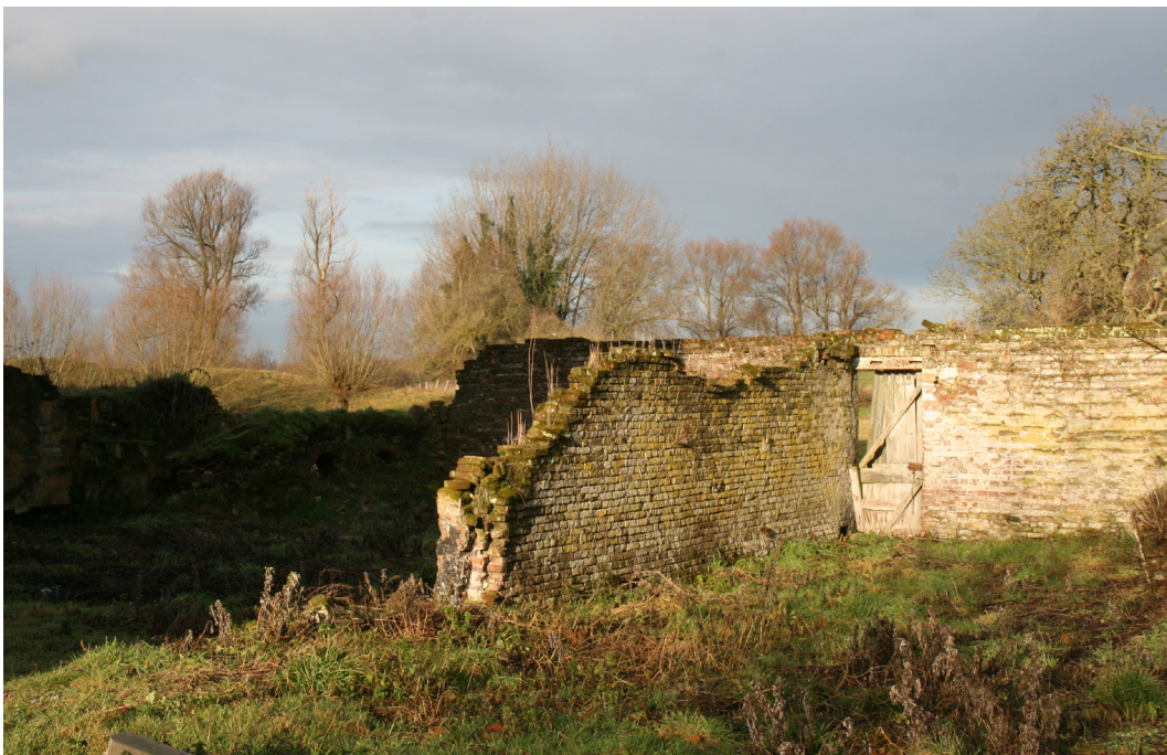
Foto 48: De bijgebouwen van de boerderij Damse Vaart-West 5 zijn zo vervallen dat restauratie amper nog mogelijk is. Foto Arnout Zwaenepoel, februari 2017.
