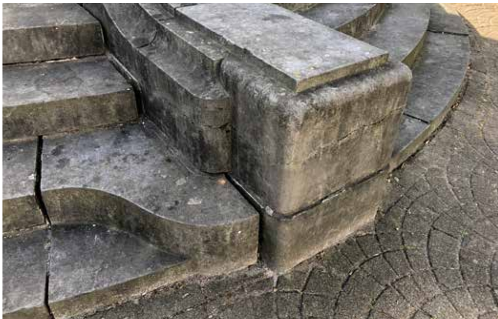
Afbeelding 19. Er zijn verschillende openstaande voegen in de trappen met waterinsijpeling tot gevolg. (© Erfgoed en Visie)
