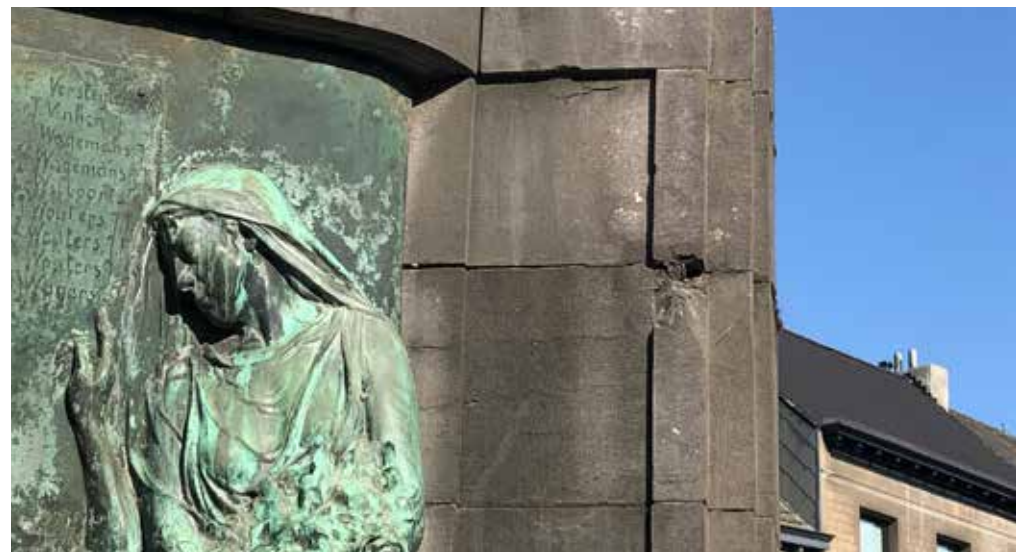
Afbeelding 22. Plaatselijke schade aan de natuursteen. (© Erfgoed en Visie)
