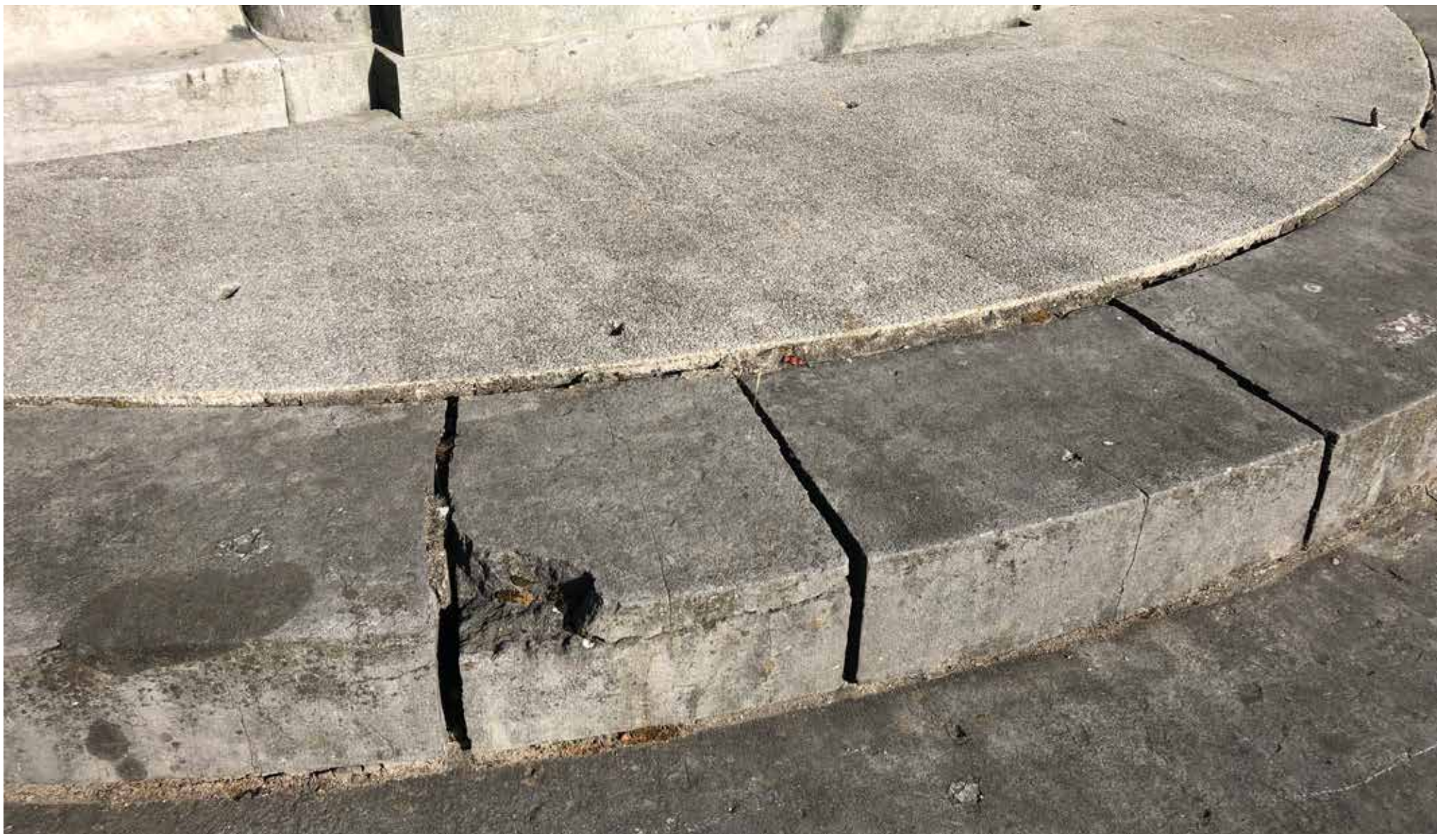
Afbeelding 18. De trappen van de sokkel zijn sterk beschadigd (© Erfgoed en Visie).
