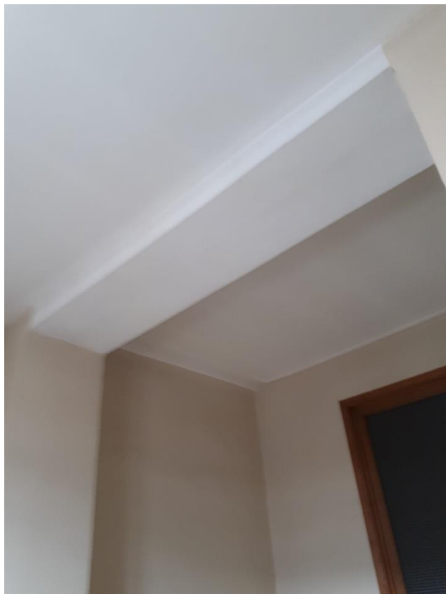
Foto A.41. Plafond eerste verdiep
