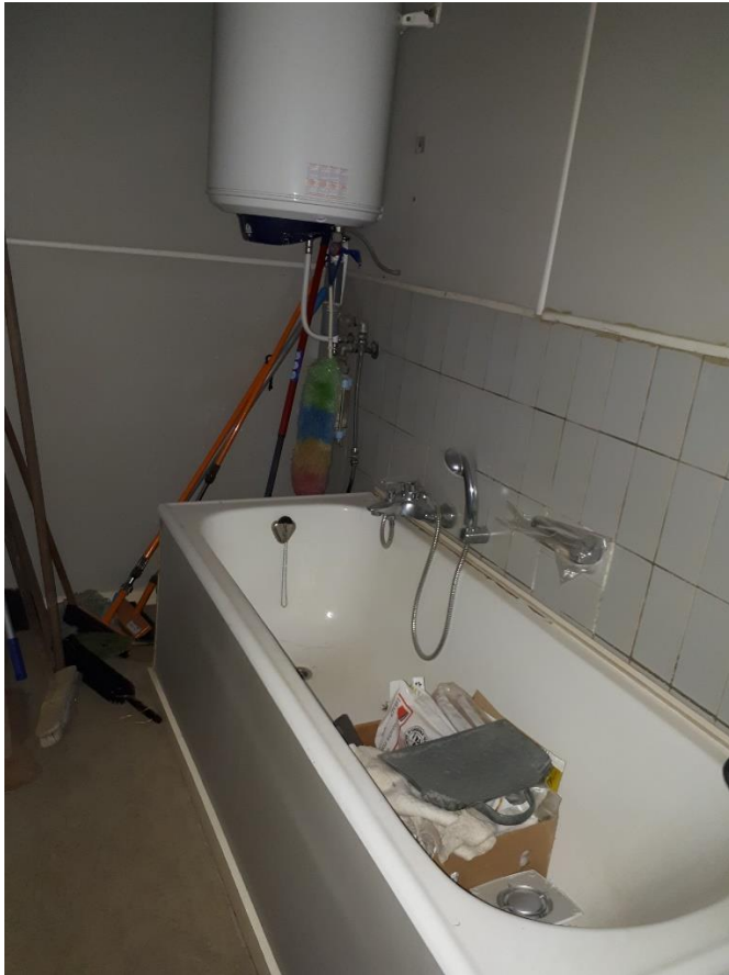
Foto A.17. Badkamer met asbestplaten en keramische tegels als muurafwerking
