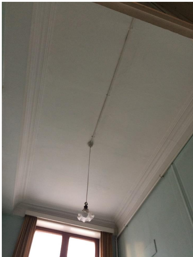
Foto A.49. Plafond eerste verdiep
