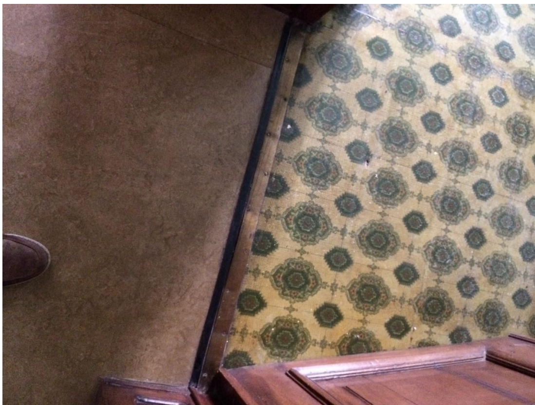
Foto A.29. Lineoleum op 1ste verdieping
