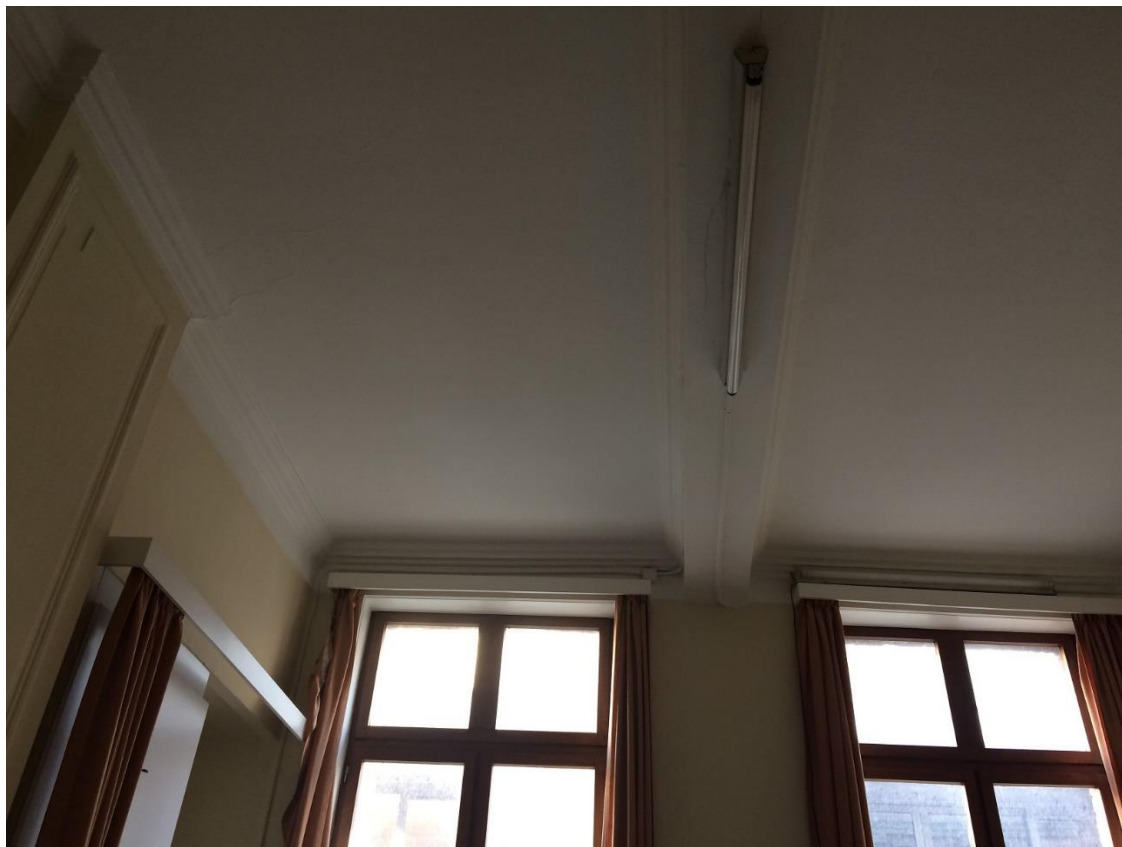
Foto A.46. Plafond eerste verdiep
