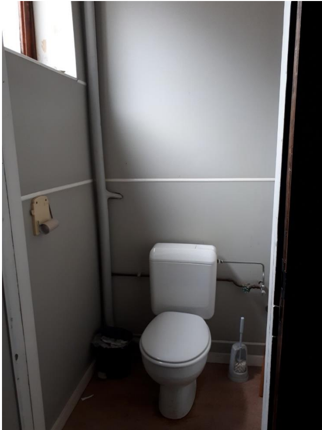
Foto A.15. Wc met asbestplaten als muurafwerking
