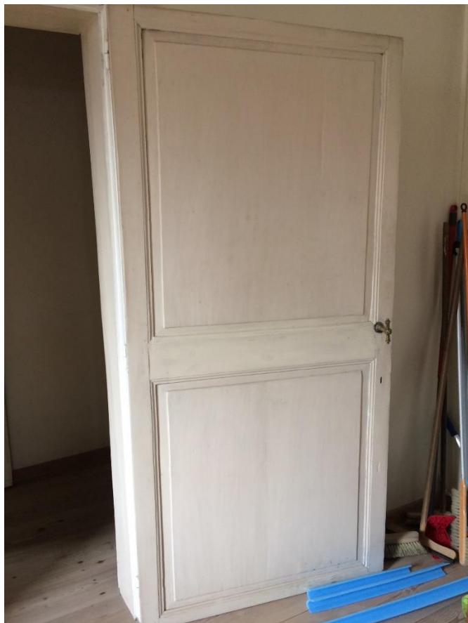
Foto A.75 Deur met erfgoedwaarde 1 ste verdiep
