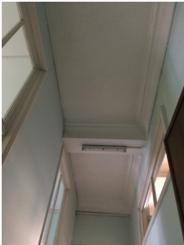
Foto A.48. Plafond eerste verdiep
