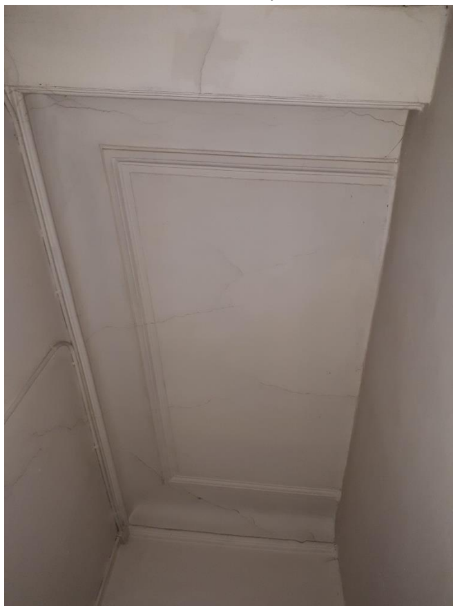
Foto A.47. Plafond eerste verdiep
