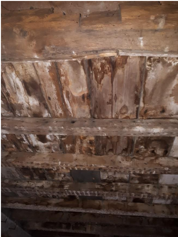
Foto A.52. Plafond. Onafgewerkte houtenplafond op 2de verdiep met zichtbare historische waterschade
