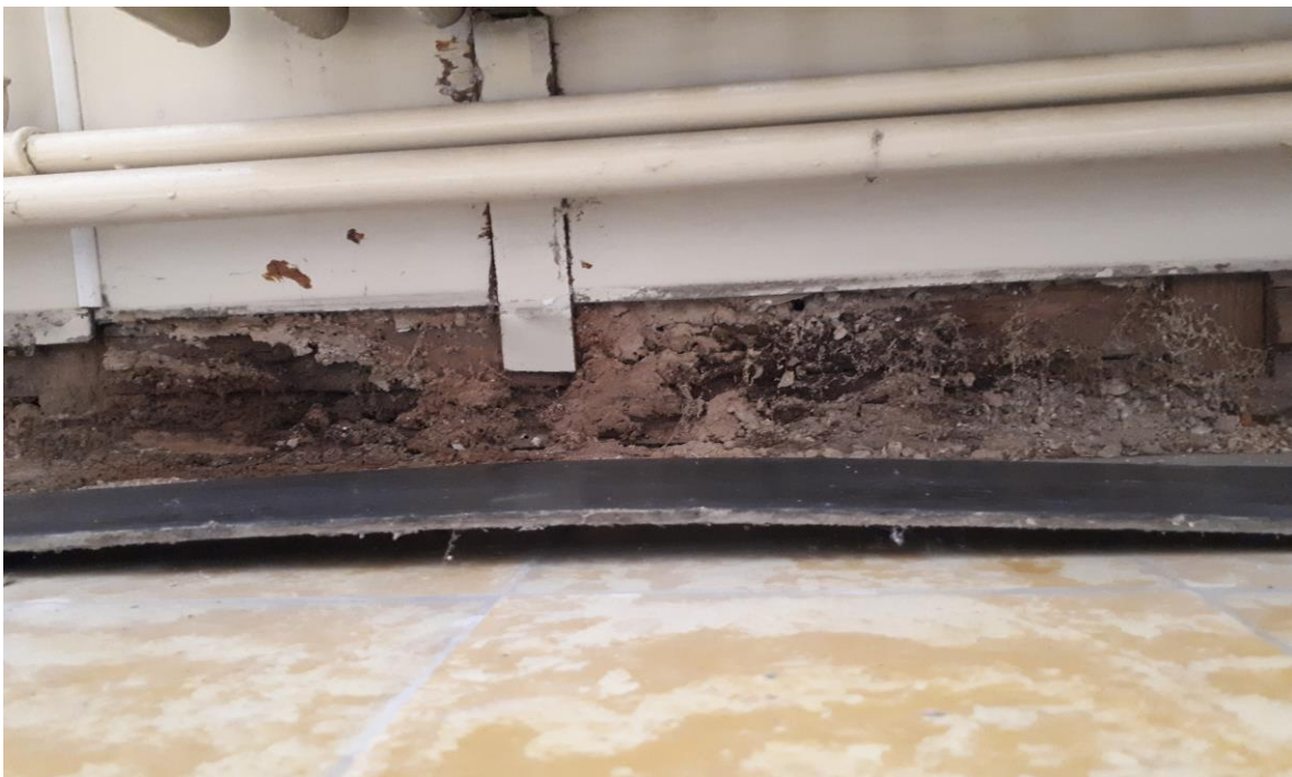
Foto A.12. Vochtschade onder asbestplint
