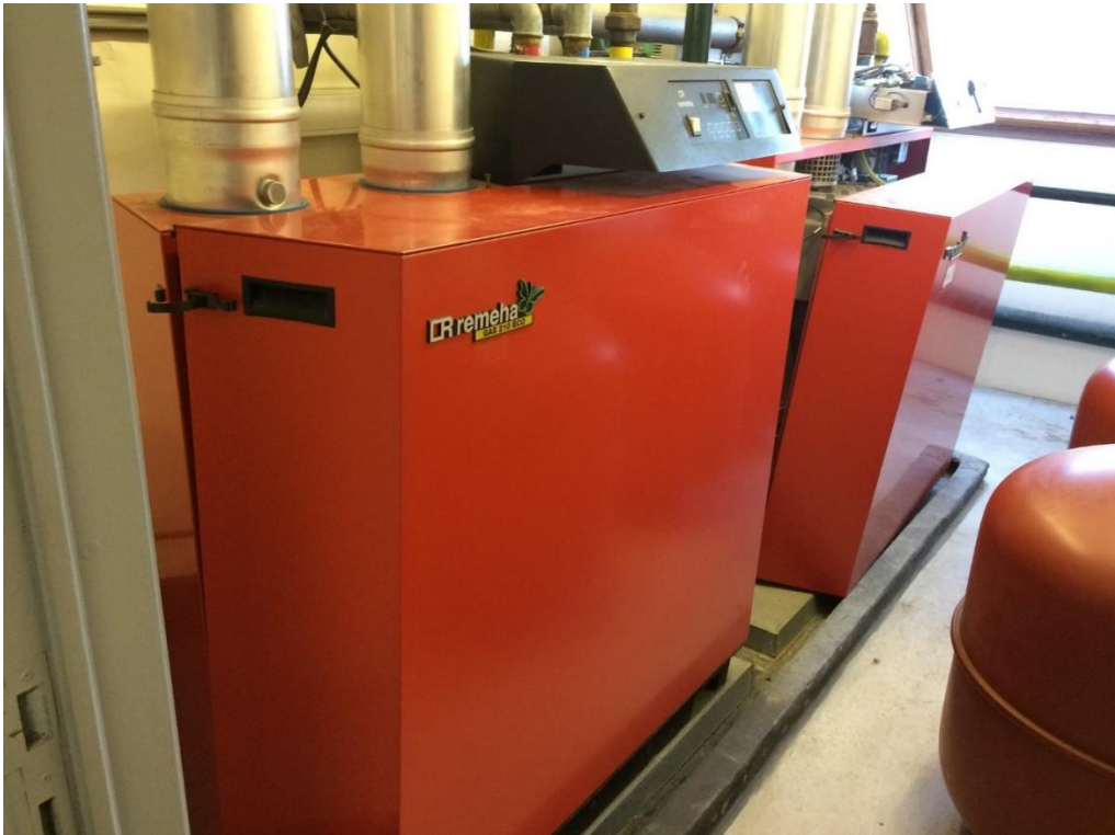
Foto A.33. Technische ruimte met een op cementgebaseerde vloer.
