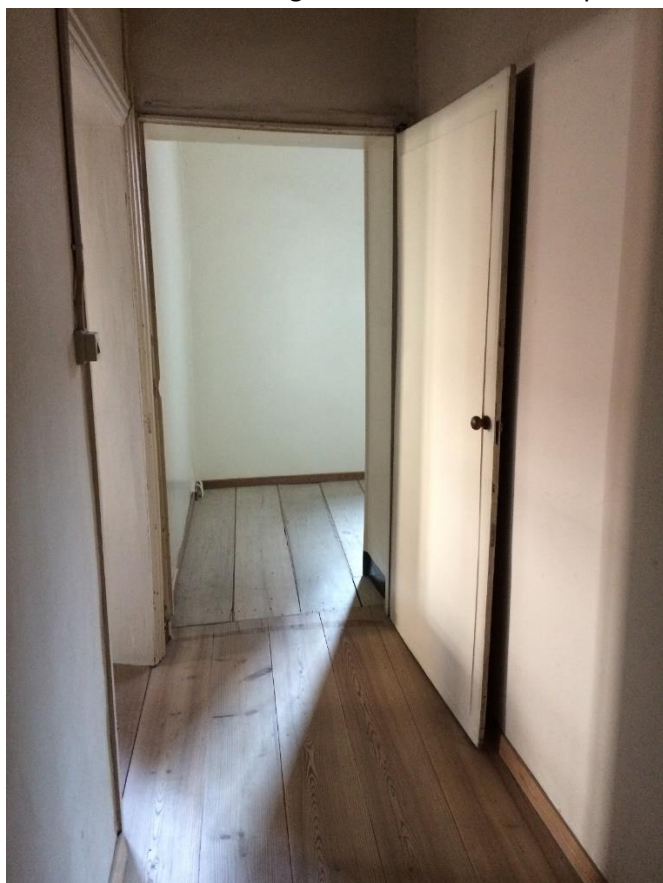
Foto A.70. Deur met erfgoedwaarde 1 ste verdiep
