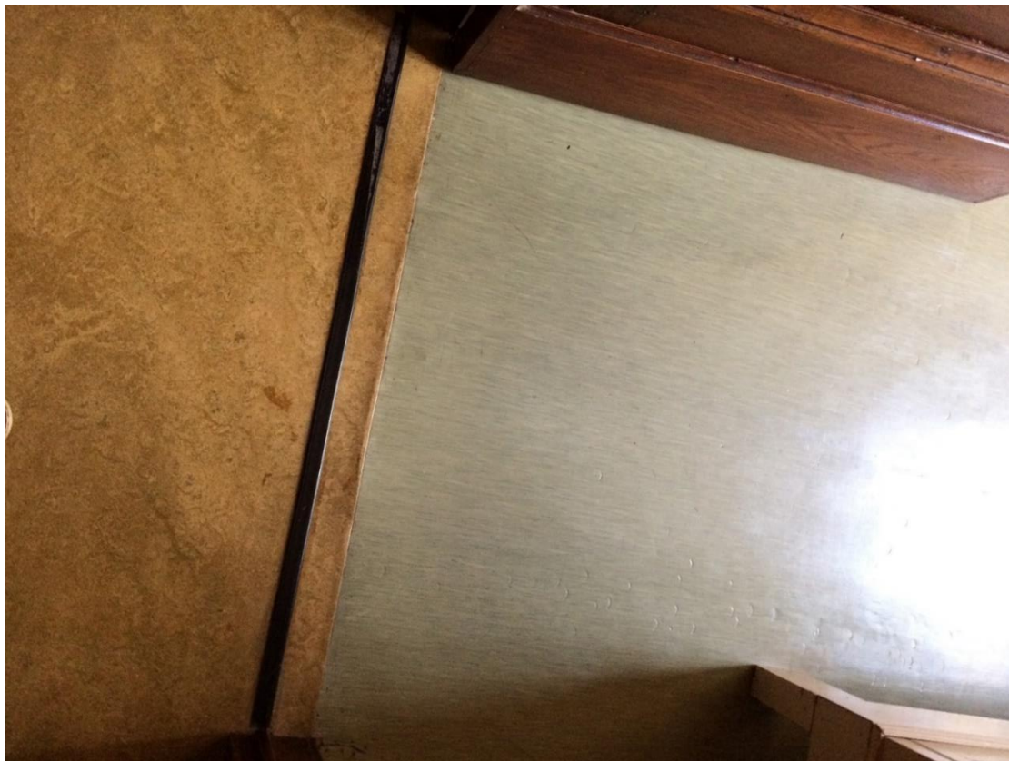
Foto A.28. Lineoleum op 1ste verdieping
