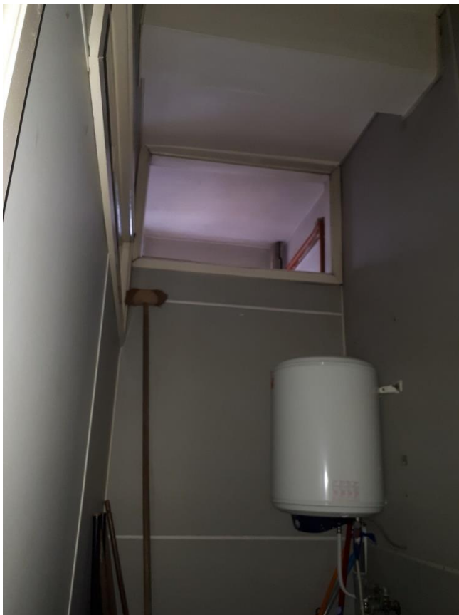
Foto A.18. Badkamer met asbestplaten en keramische tegels als muurafwerking
