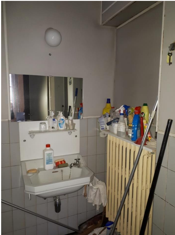
Foto A.16. Badkamer met asbestplaten en keramische tegels als muurafwerking
