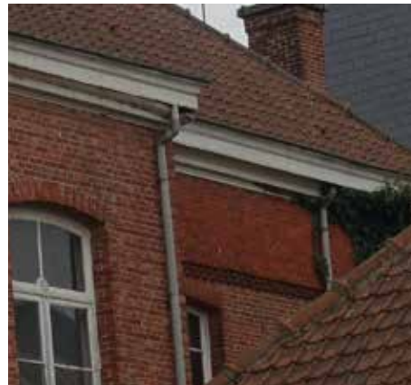
afb. 304: Losgekomen kroonlijst met regenpijp, achtergevel.
