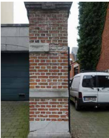
afb. 285: Beschadiging aan de simililagen in blauwe hardsteen aan poort-kolom.
