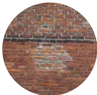
afb. 247: Storende (en schadelijke) cementvoegen.
