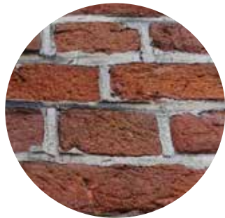
afb. 268: Slordig voegwerk, met enkel knipvoeg aan korte zijde.
