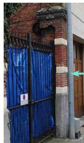
afb. 276: Toestand van de rechter pilaster van de rechtse poort op 21 februari 2019.
