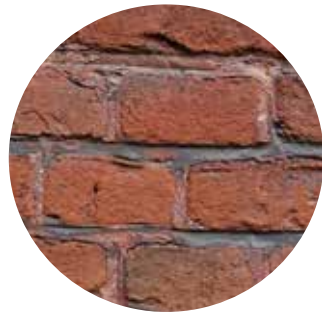
afb. 269: Storende cementvoegen in gekleurd voegwerk.
