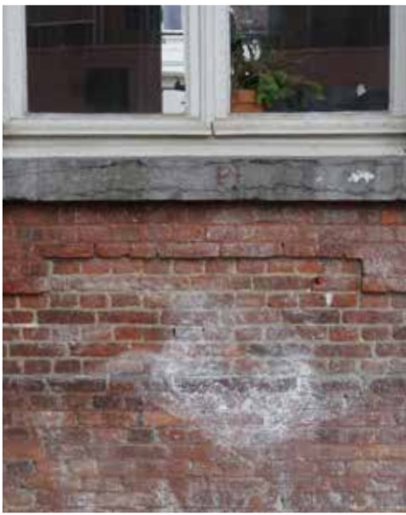
afb. 270: Storende graffiti resten op het metselwerk aan de achterzijde.
