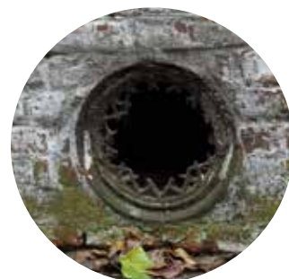
afb. 294: Beschadigd verluuchtingsrooster, zijgevel woonhuis.
