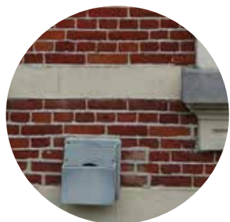
afb. 250: Storende ventilatie onderdelen.
