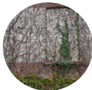
afb. 251: Storende wit overschilderde muurdelen.
