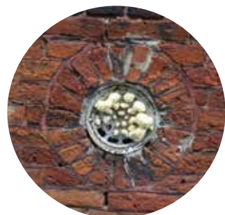
afb. 290: Verluuchtingsrooster zijgevel, met storend isolatiemateriaal.
