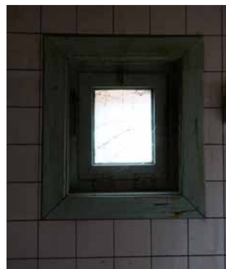
afb. 252: Storende klein venster aan de noordvleugel.
