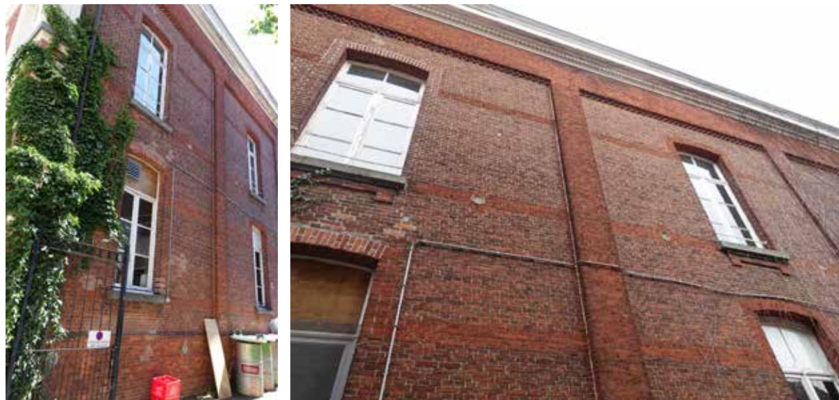
afb. 112: Zijgevel: verschil in voegwerk
