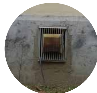
afb. 292: Recent toegevoegd verluuchtingsrooster met storende cement opvulling.
