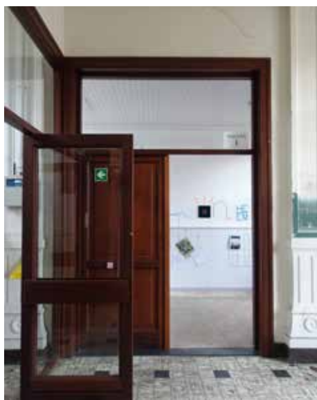
afb. 306: Binnendeur te vervangen door reconstructie-schrijnwerk en links recente binnenwand die men dient te verwijderen.
