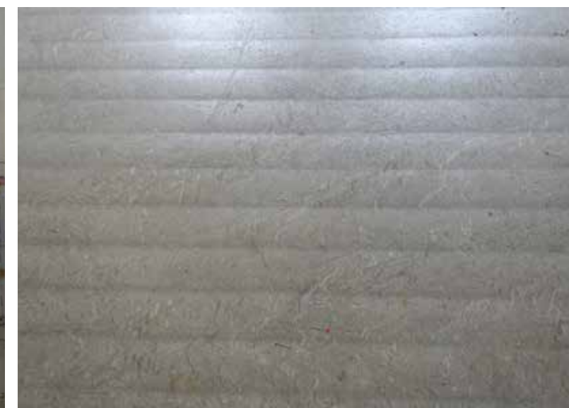
afb. 213: Huidige bevoering met onderliggende houten planken.
