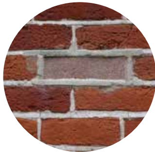
afb. 267: Storende (en schadelijke) cementvoegen, schade door het zandstralen, voorgevel.
