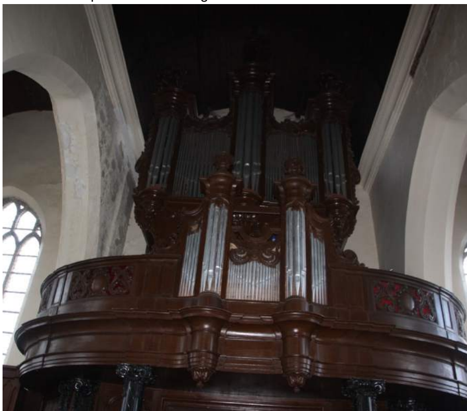
Afbeelding 155: schade aan pleisterwerk en sierlijsten (eigen foto, 2017)
