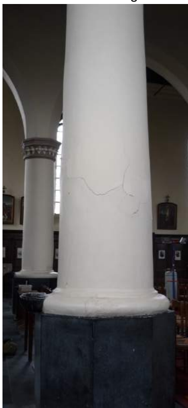
Afbeelding 154: schade aan pleisterwerk zuil (eigen foto, 2017)
