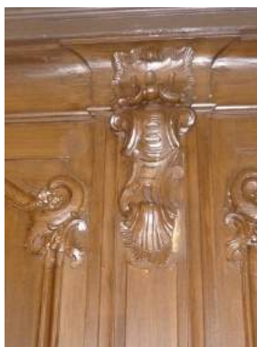
Afbeelding 189: Afgebroken onderdeel, zuidzijde schip (eigen foto, maart 2017)
