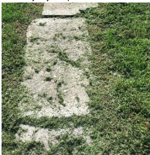
Afbeelding 249 Verzakt deel (eigen foto, 2018)
