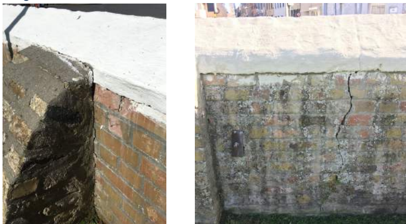
Afbeelding 246 Schadebeelden poortje en muur.
