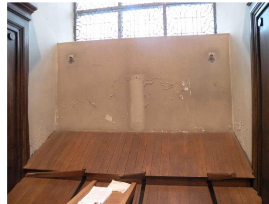
Binnenmuur onder westelijk raam, 2017.
