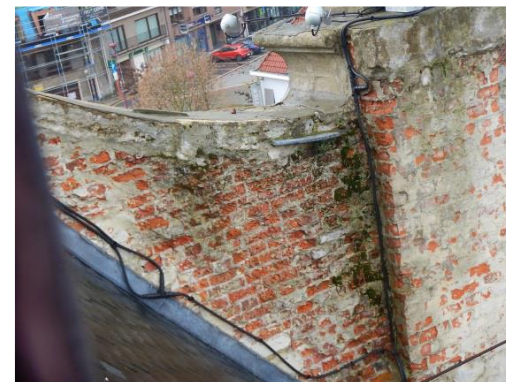
Afwerklaag achterkant voorgevel, 2018, Monumentenwacht Oost-Vlaanderen.
