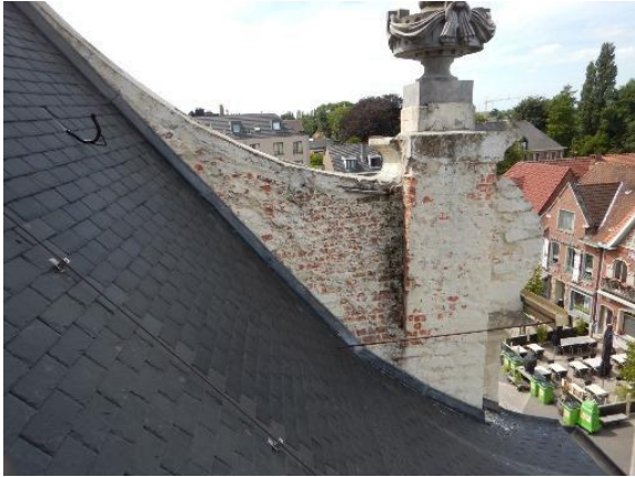
Aansluiting tegen opgaand muurwerk van voorgevel, 2015, Monumentenwacht Oost-Vlaanderen.
