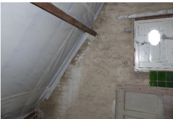
Figuur 117 Zoutuitbloeiingen door vochtinfiltratie t.h.v. aansluiting gevel en dak (2V03) (AS, 13.02.2019)
