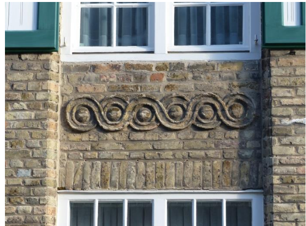
Figuur 32 Ontbrekend materiaal bij metselwerkdetails. Voeg tussen metselwerk en ramen gebarsten. (AS, 23.01.2019)
