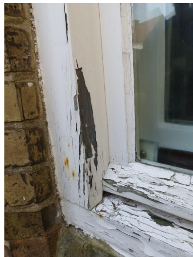
Figuur 86 Oostgevel: verf bladdert af. Oorspronkelijke kleur eronder? (AS, 13.02.2019)
