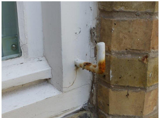
Figuur 92 Noordgevel: luikduim, gecorrodeerd (AS, 13.02.2019)
