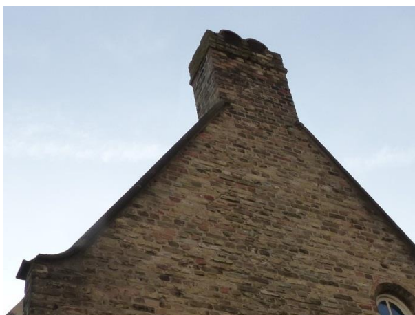
Figuur 33 Barst in puntgevel. Schouw bedekt met aarden trekelement (AS, 13.02.2019)
