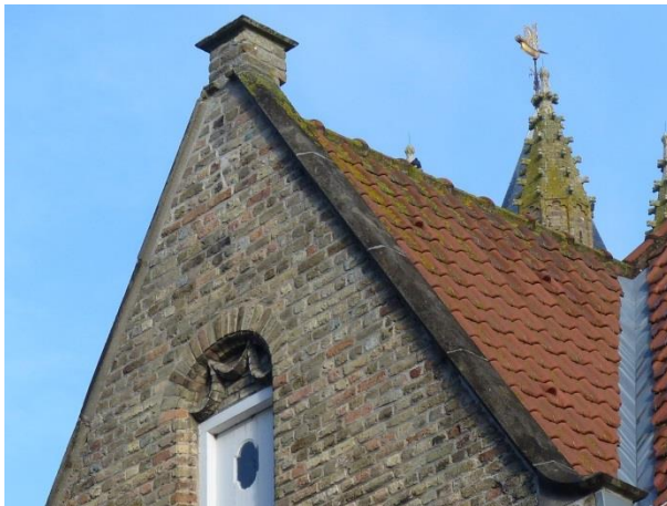
Figuur 31 Korstmossen op dekstenen. Onderliggende rij stenen hervoeegd. (AS, 23.01.2019)
