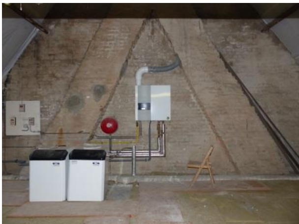
Figuur 145 Zolder (2V02): nieuwe CV-installatie (AS, 13.02.2019)
