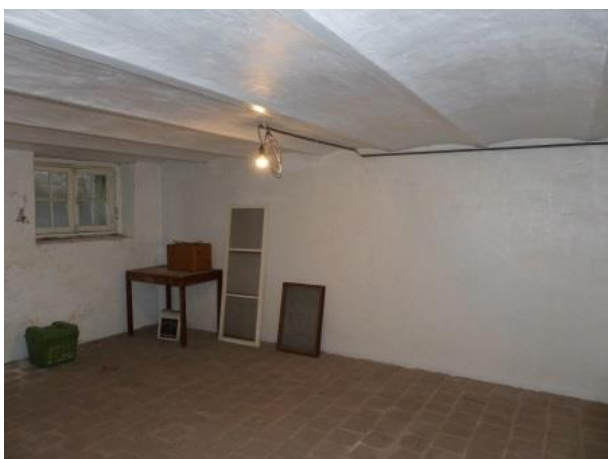
Figuur 107 Kelder (K01): bakstenen troggewelven tussen I-liggers (AS, 13.02.2019)
