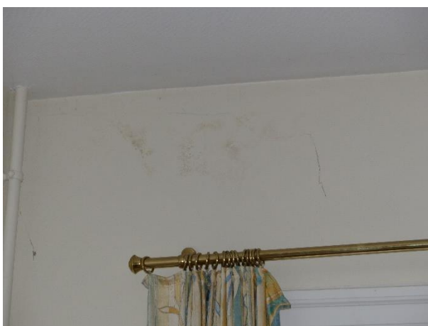
Figuur 113 Vochtinfiltratie en scheur in pleisterwerk slaapkamer (1V02) (AS, 13.02.2019)
