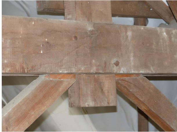
Figuur 53 Detail spant 2: korbelen sluiten niet meer aan op dekbalk en nokstijl (AS, 13.02.2019)
