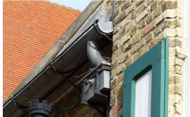
Figuur 49 Nest in vergaarbak aan voorgevel (AS, 13.02.2019)
