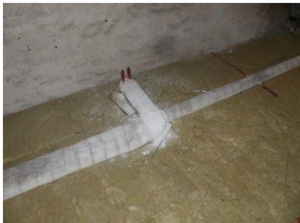
Figuur 146 asbestisolatie? (AS, 13.02.2019)
