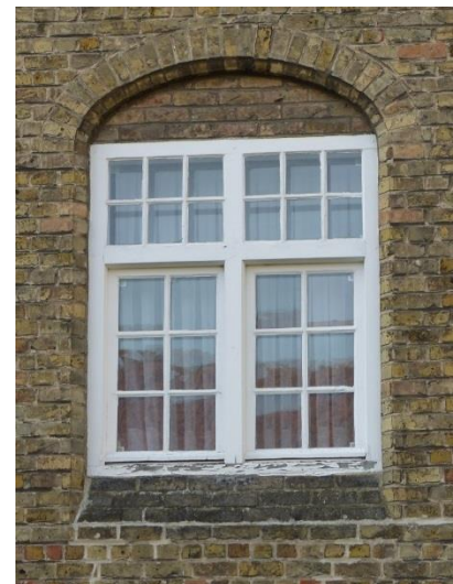
Figuur 87 Oostgevel: onderdorpel verweerd (AS, 13.02.2019)
