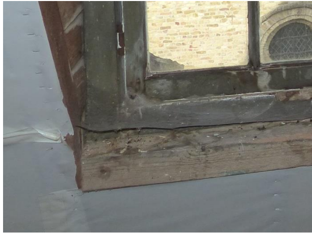
Figuur 63 Nieten niet afgeplakt. Tape over naden komt op sommige plaatsen los (AS, 13.02.2019)
