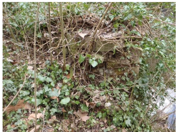
Sterk beschadigd metselwerk bovenaan het noordoostelijk bruggenhoofd
