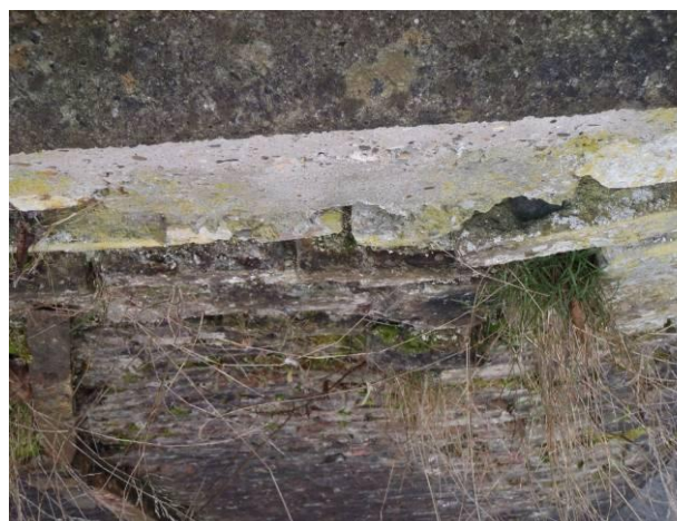
Sterk beschadigd metselwerk onder de slechte muurbekroningen
