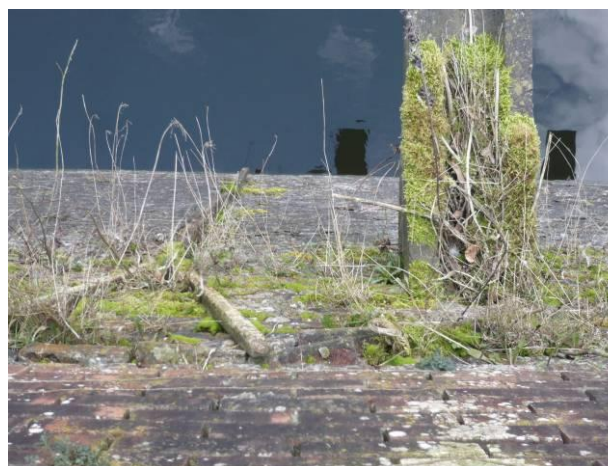
Roestige en gebroken muurankers
