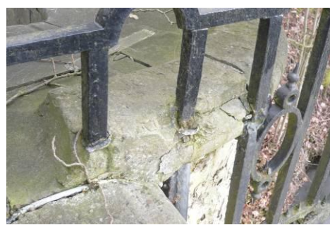
Steenschade ten gevolge roest
