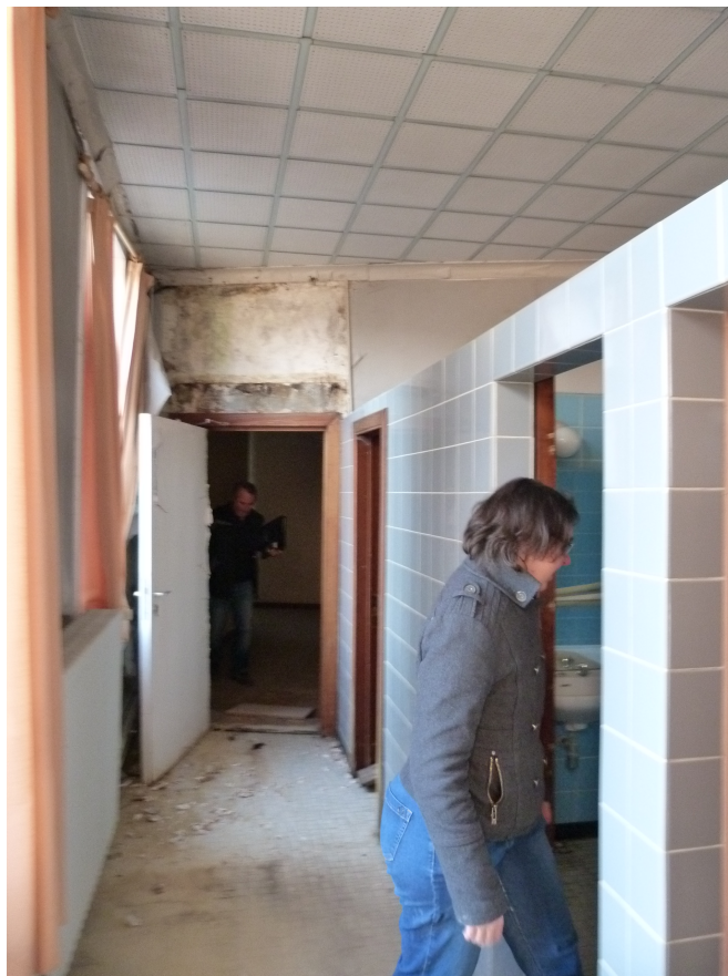
Foto I - Sanitair lokaal straatvleugel 1 e verdieping
