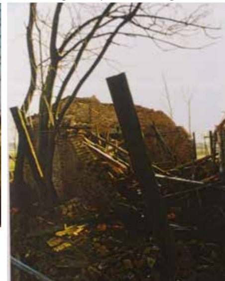
afb. 159: Ingevallen voorbereidingsgebouw, 1998-01-09 © J. Martens.
