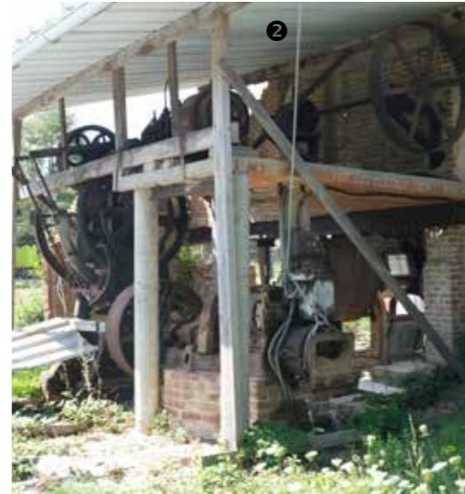
afb. 35: Machinerie in het voorberekingsgebouw, kamer, 2, huidige toestand © foto 22-08-2019.
