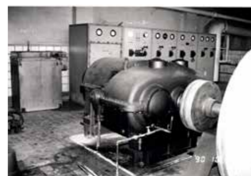
afb. 155: Machinekamer 1, achteraan reductiekast, Dakpannenfabriek De Pottelberg, Kortrijk © Agentschap Onroerend Erfgoed.
