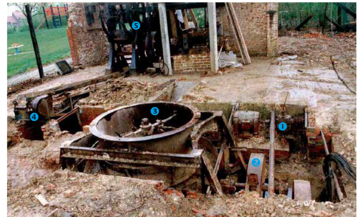
afb. 243: Motor met schakelkast (nr. 1) en tandwielen (nr. 2) voor mengkuip aan te drijven (nr. 3), links: transportband afvoer (nr. 4) en vormpers (nr. 5) © J. Martens, "Rehabilitatie van de site Panoven Loksbergen", FOTODOSSIER, 1997-1998, Provincie Limburg, Stad Halen, Beschermingsdossier De Panoven, Archief Onroerend Erfgoed, Provincie Limburg.
