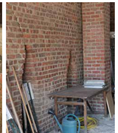
afb. 203: Interieur, scheur laadruimte 1, ovengebouw © foto 22-08-2019.
