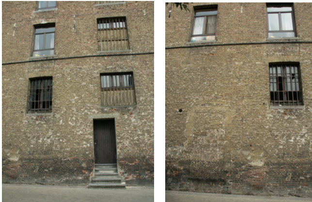
Gevel klapstraat met metselwerk in slechte staat
