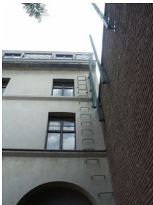
Ladder bevestigd aan de binnengevel van pand B
