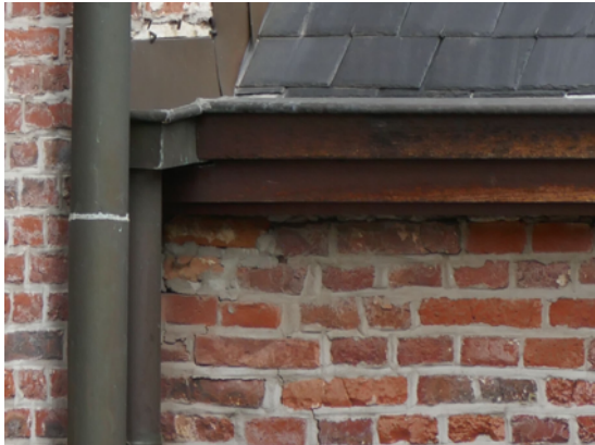
Scheur in metselwerk
