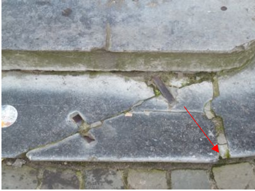
Buitentrap aan de voorgevel is gescheurd
