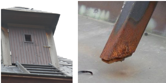
Roestaantasting aan de voeten van de dakladder
