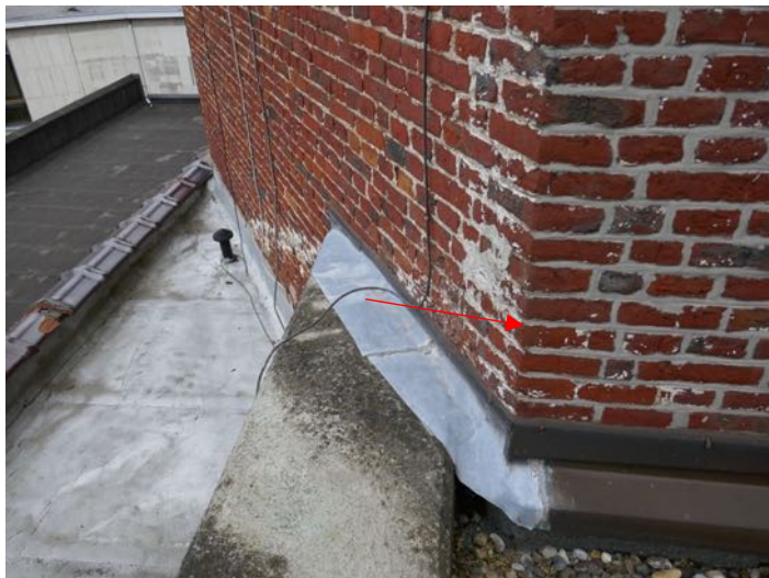
Slechtgeplaatste loodslabben bij koorsluiting
