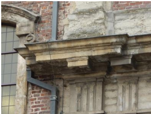
Beschadiging kalkzandsteen in de voorgevel
