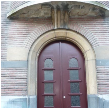
betonrot kunststeen in de voorgevel
