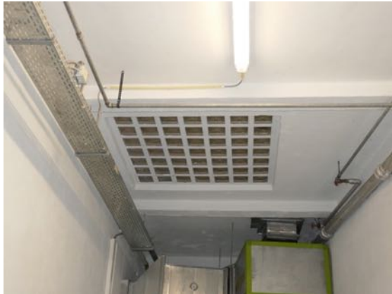
Glasdallen in het plafond van de kelderverdieping;
