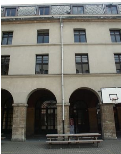
Regenwaterafvoer pand B
