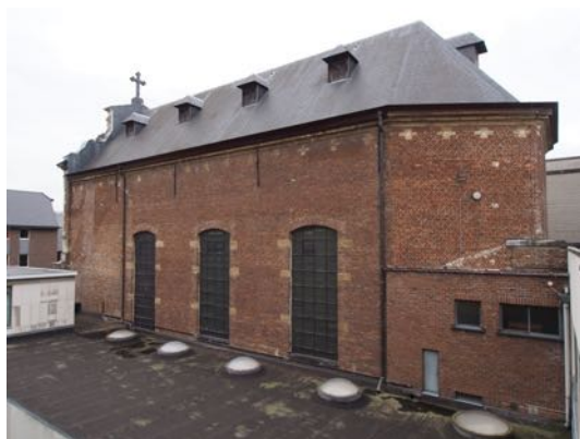
Noordwestelijke zijgevel met schade in metselwerk
