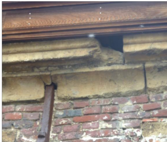
Beschadiging kalkzandsteen bij de noordwestgevel
