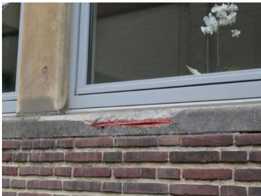
Reeds behandelde zichtbare wapening
