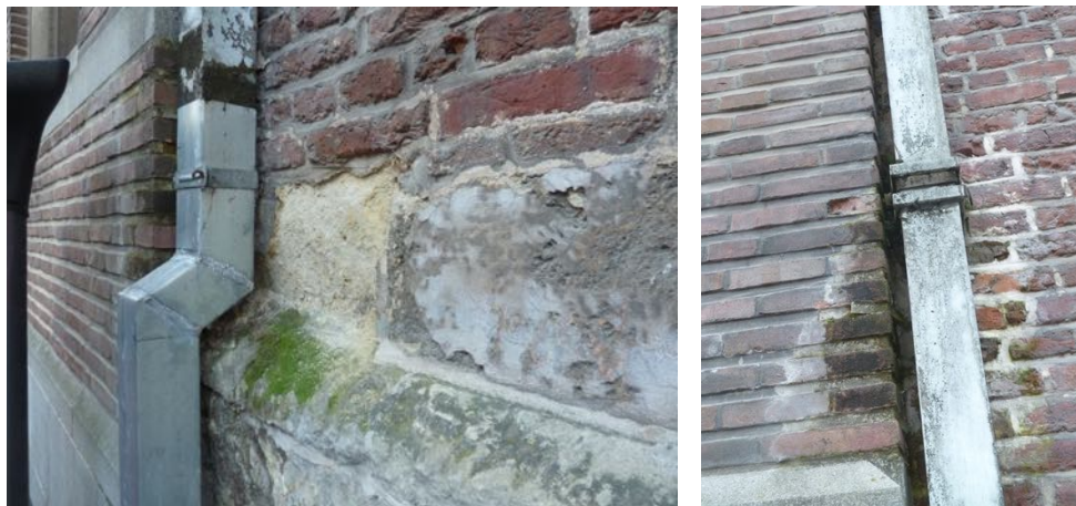
Afvoergoot met lekkage rechts bij de voorgevel
