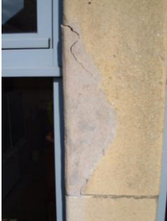
Beschadigde kolom in kunststeen
