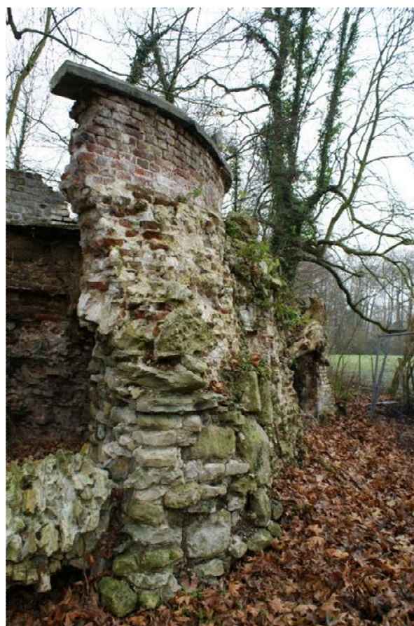
Zicht op de half ingestorte constructie
